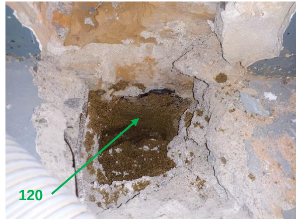
Kuva 32. Sokkelirakenne on märkä, pintakosteusarvot 120, vrt 80.
