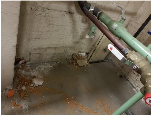
Kuva 44. Kosteusvauriojälkiä laajalti lämpökeskuksen seinärakenteissa. Osa 2, kellari.
