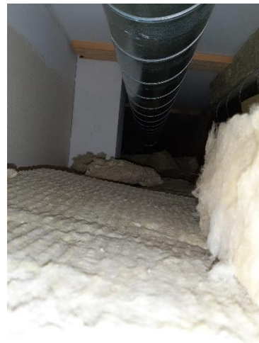
Kuva 119. Runsaasti mineraalivillaa kotelorakenteen sisällä.
