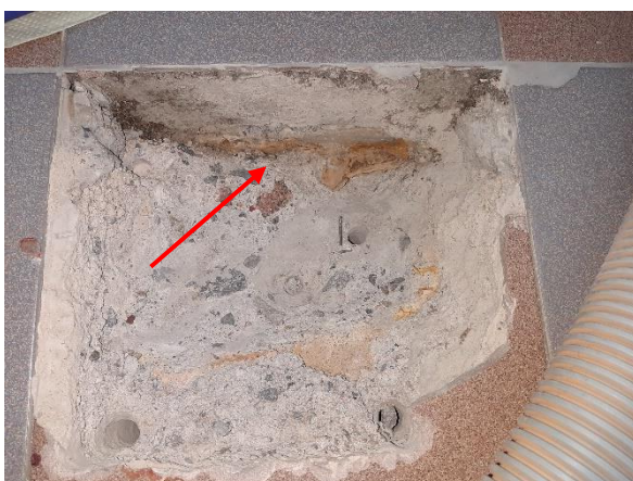
Kuva 72. Tutkimuspisteen RAK4 kohdalla on liikuntasäily. Liikuntasäilyä eristeestä otetun materiaalinäytteen mikrobi-analyysitulokset viittaavat vaurioon.
