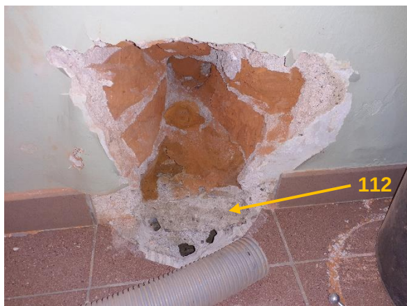
Kuva 26. Tutkimuspiste sijaitsee ulkoseinän vieressä. Lattian betonirakenne on märkä ulkoseinän vieressä: pintakosteusarvot 112, vrt 80.
