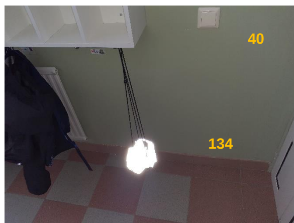
Kuva 41. Pintakosteusarvot koholla seinän alaosassa. Osa 1, kellari, käytävä 05.
