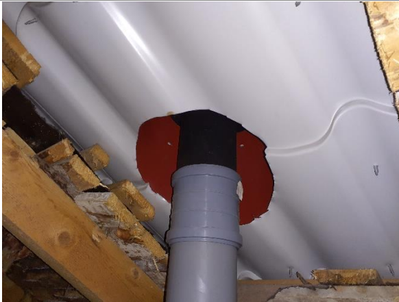
Kuva 76. Viemärin tuuletusputken läpivientikohdalta vesikate vuotaa. Myös tämä paikka iv-konehuoneen läheisyydessä.
