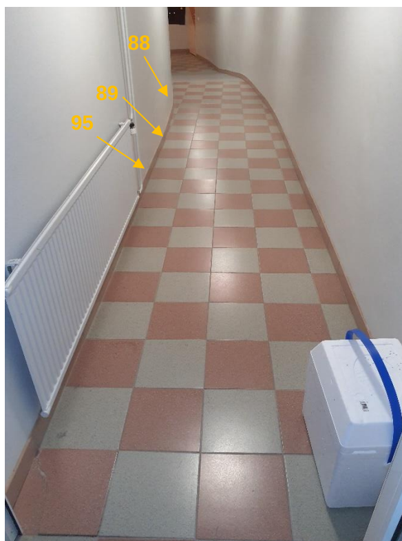
Kuva 57. Pintakosteusarvot koholla väliseinän alaosassa. Osa 2, kellari, käytävä 010.
