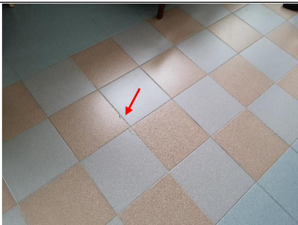
Kuva 70. Tutkimuspiste RAK4. Osa 1. 2. kerroksen käytävällä on lattianpinnoite ollut rikki ja se on paikattu.
