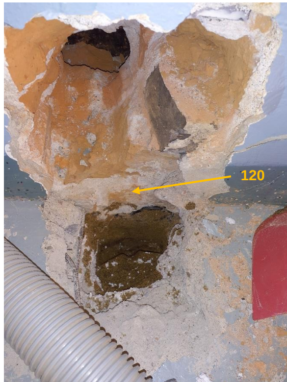
Kuva 49. Pintakosteusilmaisimen perusteella seinän tiilirakenne on märkä.
