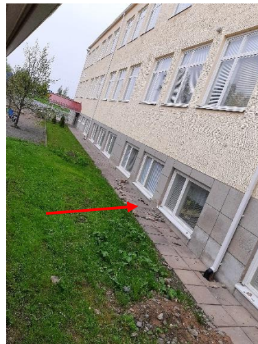
Kuva 7. Rakennuksen osa1:n lounaissivulla on rakennuksen viereisiä laattoja muutettu siten, että ne viettävät rakennuksesta poispäin.
