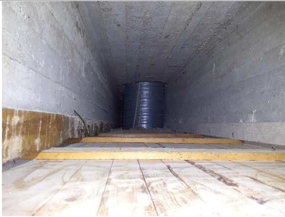
Kuva 86. Näyttämön takana on epätiivis läpivientikohta.
