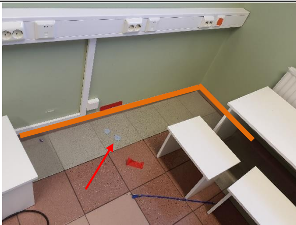
Kuva 33. Esikoulun leikkutilassa syötettiin kaasua alapohjarakenteen sisällä kulkevaan putkikanaaliin punaisen nuolen osoittamasta kohdasta (M1). Kaasua havaittiin tulevan sisäilmaan oranssilla merkitystä kohdasta.
