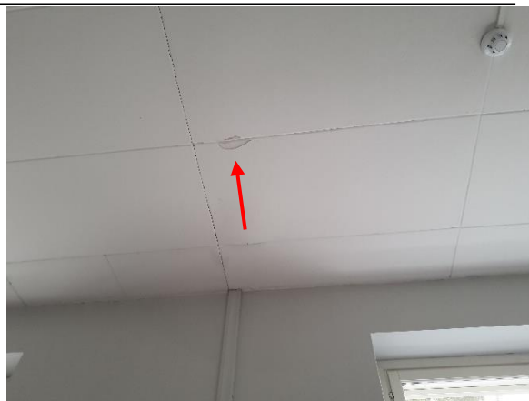
Kuva 71. Osa 1. 1. kerroksen käytävällä on kattopinnoitteessa kosteuden aiheuttamia jälkiä tutkimuspiste RAK4 kohdalla.
