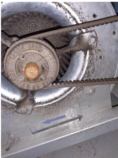
Kuva 98. Keittiön poistoilmahuuhallin. Puhaltimen pinnoilla on runsaasti rasvaa.
