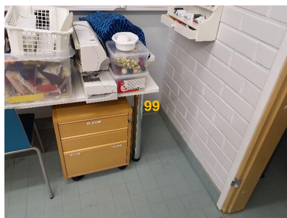
Kuva 43. Pintakosteusarvot koholla seinän alaosassa. Osa 2, kellari, tekstiilityöluokka 015.
