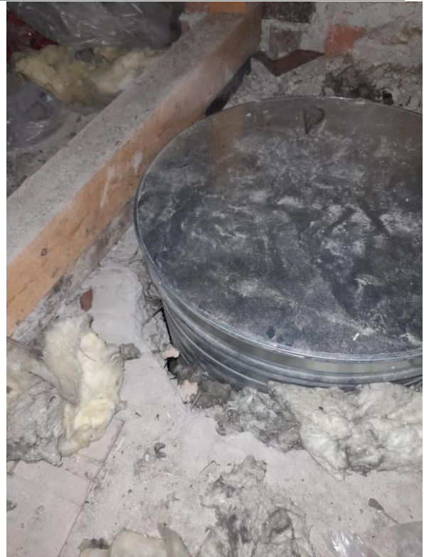
Kuva 91. Kuva liikuntasalin ullakkotilasta. Iv-läpivienti yläpohjarakenteessa on epätiivis. (Kuva Paavo Vainio)
