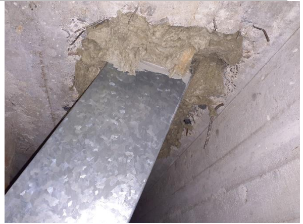
Kuva 87. Läpivientikohta täytetty mineraalivillalla.
