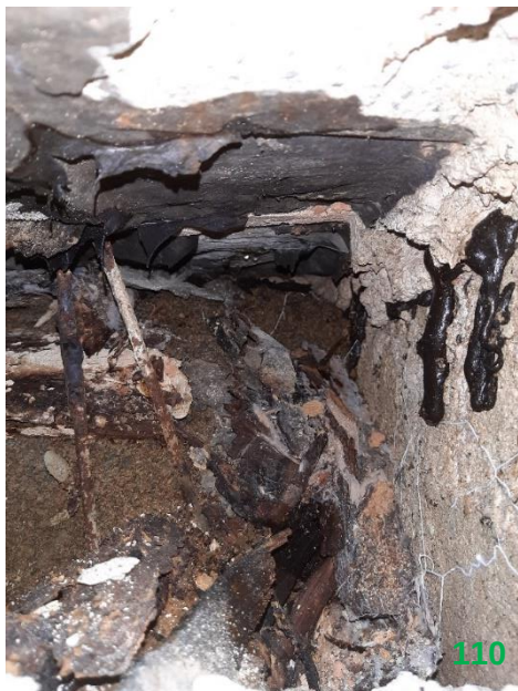
Kuva 30. Kuva tutkimuspisteestä keittiön suuntaan päin kuvattuna. Kanaali päättyy tai se on täytetty hiekalla. Sokkeli on märkä, pintakosteusarvo 110, vrt 80.
