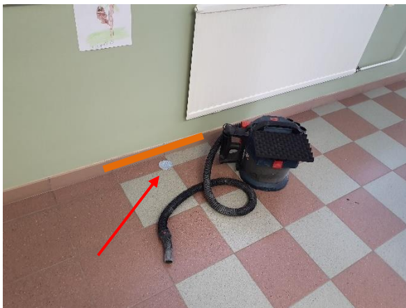
Kuva 35. Ruokalan kohdalla käytävällä 05 syötettiin kaasua alapohjarakenteen pintabetonilaatan alapuolelle tutkimuspisteessä M2. Kaasua todettiin tulevan lattia- ja seinärakenteen liittymästä huonetilaan.
