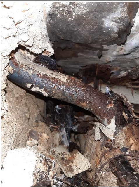
Kuva 28. Tutkimuspisteen kohdalla putkikanaalista menee putki sokkelirakenteen sisälle. Putkikanaalissa on märkää orgaanista materiaalia sekä mahdollisesti putkieristeissä asbestia.
