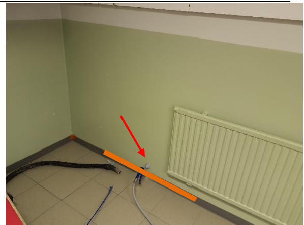
Kuva 51. Tutkimuspiste M5. Esikoulun pientilassa 070 syötettiin kaasua ulkoseinän eristetilään. Kaasua tuli huonetilaan lattia- ja seinärakenteiden liittymästä oranssilla merkitystä kohdasta.
