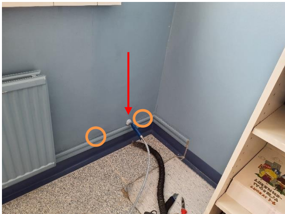
Kuva 64. Kaasu syötettiin nuolen osoittamasta kohdasta ulkoseinän eristetilaan ja kaasun todettiin tulevan sisäilmaan oranssilla merkityistä kohdista.
