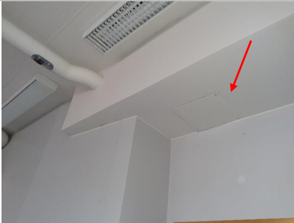
Kuva 117. Luokka 5. Kotelorakenteita, joissa epätiivitä luokkuja.
