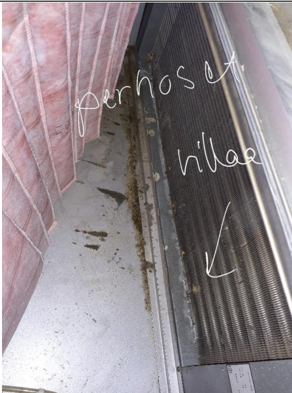
Kuva 96. Keittiön tuloilmakone. Lämmityspatteri on likainen. Siinä on mm. mineraalivillaa ja hyönteisiä.
