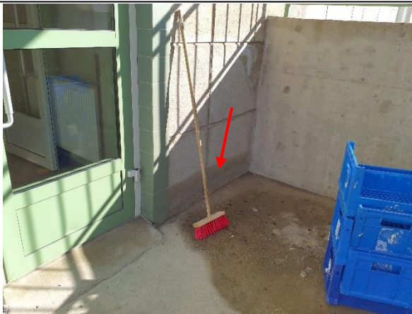
Kuva 8. Keittiön ulko-oven oikealla puolella kosteusjälkiä seinän alaosassa.
