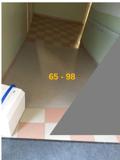
Kuva 18. Porrashuoneen 06 luiskassa on muovimattopinnoite, jonka alueella pintakosteusarvot olivat paikoin koholla, yli 80.
