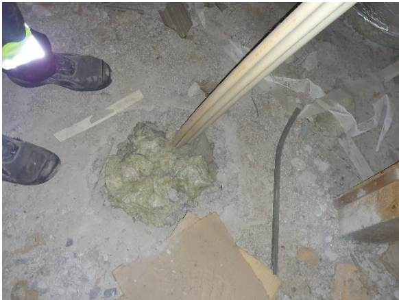
Kuva 82. Epätiivis läpivientikohta yläpohjarakenteessa.
