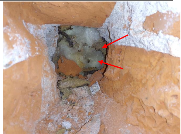
Kuva 46. Ulkoseinän eristetilassa on rakennuspahvi ja mineraalivilla. Mikrobianalyysin perusteella paperissa todettiin heikko viite vauriosta ja mineraalivillassa viite vauriosta.
