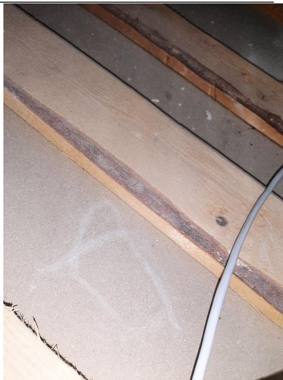
Kuva 121. Kotelo sisäpinnalla pölykertymää. Ruokala
