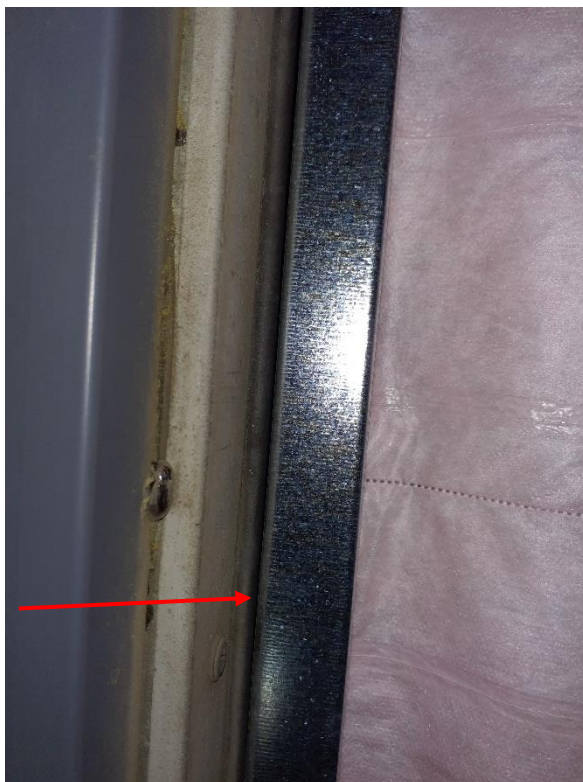
Kuva 101. Luokkien kone. Suodatinkehys ei ole tiivis.
