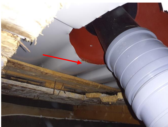
Kuva 74. Viemärin tuuletusputken läpivientikohdalta vesikate vuotaa iv-konehuoneen läheisyydessä.
