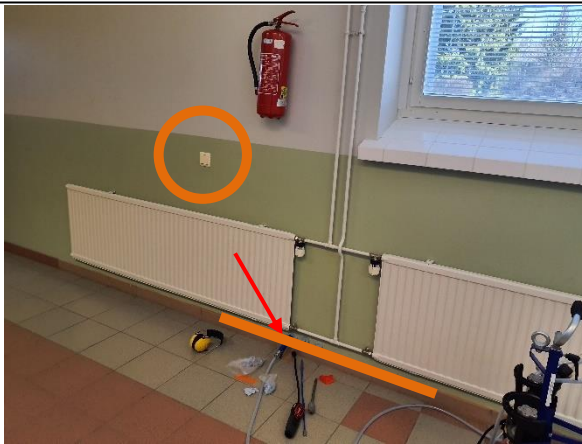
Kuva 50. Tutkimuspiste M4. Keittiön kohdalla käytävällä 05 syötettiin kaasua ulkoseinärakenteen eristetilään. Kaasua todettiin tulevan lattia- ja seinärakenteen liittymästä sekä sähköläpiviennin kohdalta huonetilaan.
