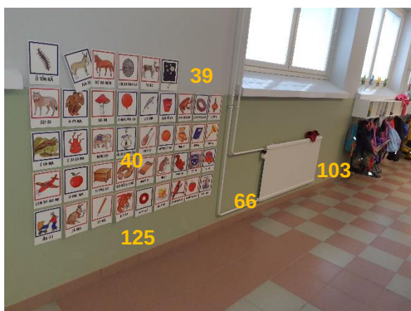
Kuva 40. Pintakosteusarvot koholla seinän alaosassa. Osa 1, kellari, käytävä 05.
