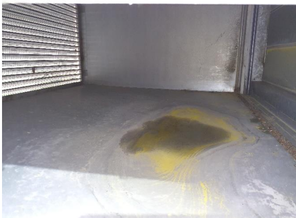
Kuva 99. Luokkien tuloilmakone. Raitisilmakammion pohjalla on jälkiä kosteudesta ja siitepölyä.
