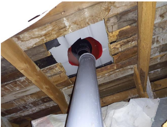
Kuva 78. Viemärin tuuletusputki on irti liitoksistaan.
