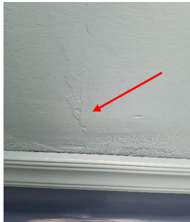
Kuva 65. Seinäpinnassa on halkeama kohdassa, mistä kaasua tuli huonetilaan.
