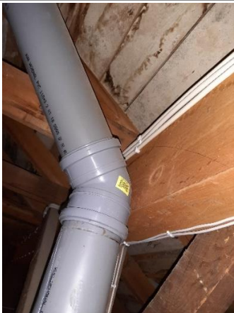
Kuva 80. Ullakkotilan sisäänkäynnin lähellä oli viemärin tuuletusputki irti liitoksistaan ja vettä oli vuotanut yläpohjarakenteen betonilaatan päälle.
