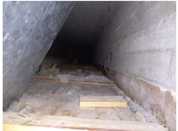
Kuva 89. Yläpohjarakenteen sisällä on runsaasti rakennusmateriaaliperäistä jätettä.
