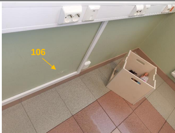
Kuva 55. Kosteusvaurioita seinän alaosassa ja pintakosteusarvot koholla. Esikoulun leikkutila ruokalan vieressä.
