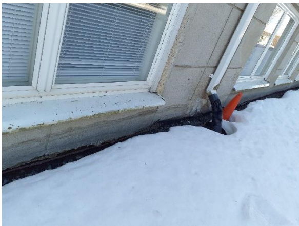
Kuva 10. Kuva rakennuksen koillissivulta, jossa syöksytörvestä tuleva vesi on johdettu putkella suoraan rännikaivoon. Sadevesijärjestelmä on uusittu kyseisellä rakennuksen sivulla.
