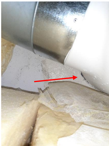
Kuva 118. Kuva kotelorakenteen sisältä, missä on epätiivis läpivientikohta hormirakenteeseen.
