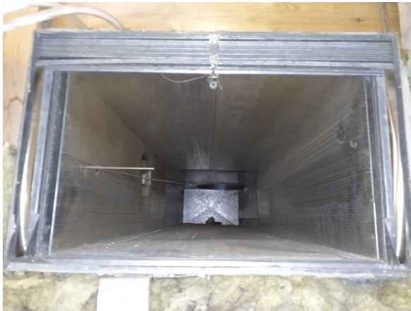
Kuva 88. Näyttämön takana on avoin ilmanvaihtokanava.
