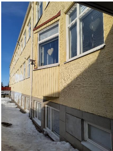
Kuva 6. Lounaissivulla maanpinta viettää rakennukseen päin. Osa 1.
