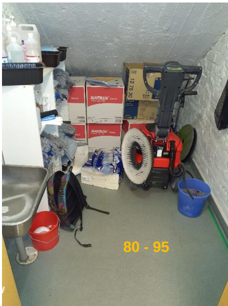
Kuva 16. Pintakosteusarvot koholla lattiarakenteessa, yli 80. Porrashuoneen 06 siivouskomero.
