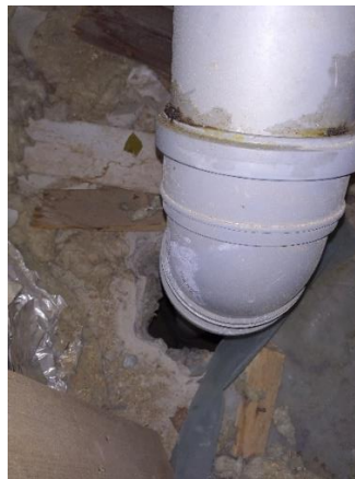
Kuva 83. Epätiivis läpivientikohta yläpohjarakenteessa.
