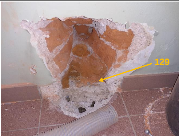
Kuva 45. Tutkimuspisteessä RAK1 seinän tiilirakenne on märkä lähellä rakenteen sisäpintaa. Pintakosteusarvo 129, vrt 80.
