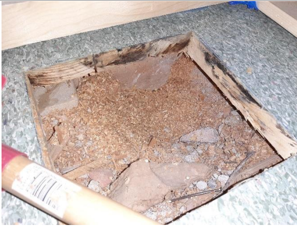
Kuva 66. Liikuntasalin varaston tutkimuspisteessä RAK5 välipohjan eristeenä on n. 300 mm kutterilastua.
