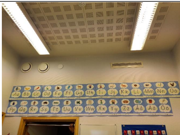
Kuva 103. Pienryhmätilassa 110 tilojen käyttäjät kokevat ilmanvaihdon riittämättömyyden tunnetta. Osa 1, 1. krs.
