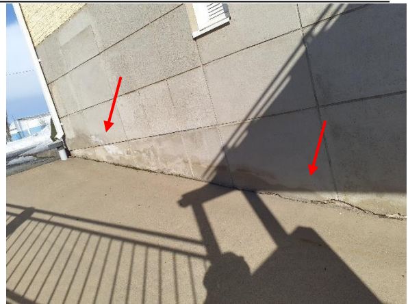
Kuva 9. Keittiön ulko-ovelle johtaa luiska, jonka yläosassa on syöksytörvi. Ulkoseinässä on kosteuden aiheuttamia jälkiä luiskan osalla.
