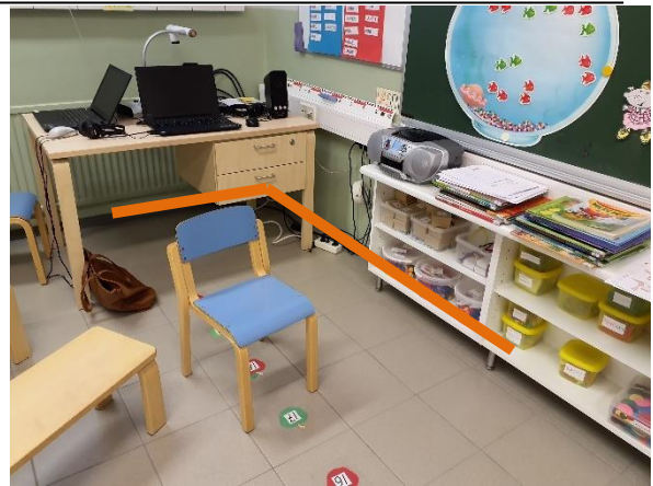
Kuva 34. Kun kaasua syötettiin esikoulun leikkutilan lattiarakenteeseen, kaasua havaittiin tulevan sisäilmaan myös luokkatilaan 029 oranssilla merkitystä kohdasta.
