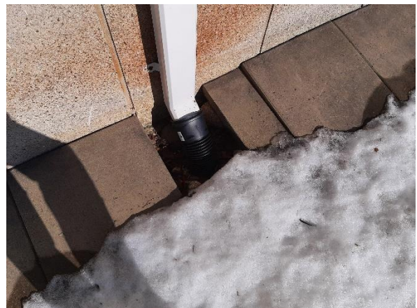
Kuva 11. Myös rakennuksen lounaissivulla, missä ei ole uusittu sadevesijärjestelmää, on syöksytörvestä vesi johdettu suoraan rännikaivoon.
