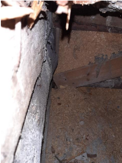
Kuva 68. Tutkimuspisteessä RAK3 (Luokka 2, tila 104) välipohjan ontelotilan pohjalla oli kutterilastua. Ontelossa oli muottilaudat paikoillaan ja ne olivat paikoin lahoja.
