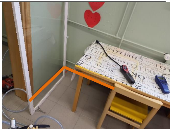
Kuva 37. Kun kaasua syötettiin tutkimuspisteessä M3 lattia-rakenteeseen, kaasua havaittiin tulevan myös pienluokkatilan sisäilmaan 028 oranssilla merkityistä kohdista.
