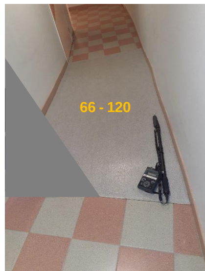
Kuva 19. Käytävän 010 luiskassa on muovimattopinnoite, jonka alueella pintakosteusarvot olivat paikoin koholla, yli 80.
