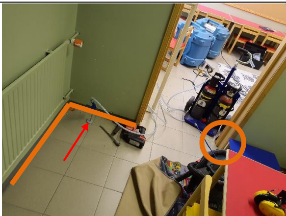
Kuva 36. Esikoulun pientilassa 070 syötettiin kaasua alapohjan betonirakenteen alapuolelle tutkimuspisteessä M3. Kaasua tuli huonetilaan oranssilla merkityistä kohdista.
