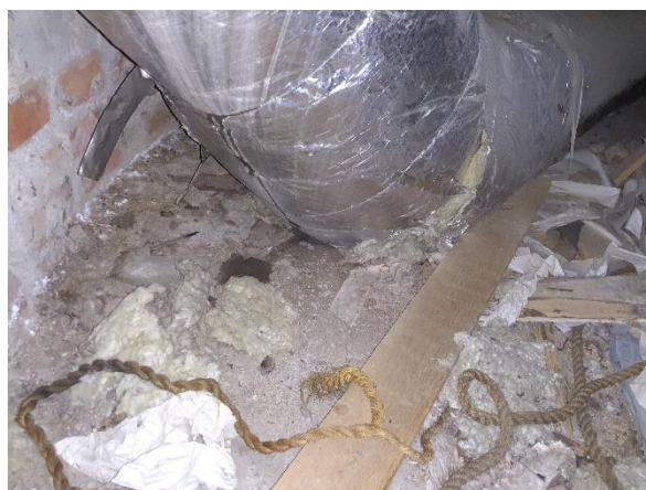
Kuva 75. Sama kohta kuin edellinen kuva. Vettä on valunut iv-kanavan eristeisiin ja siitä edelleen ullakkotilan lattialle.
