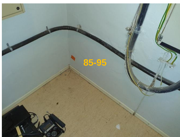
Kuva 42. Pintakosteusarvot koholla seinän alaosassa. Osa 2, kellari, sähköpääkeskus 026.
