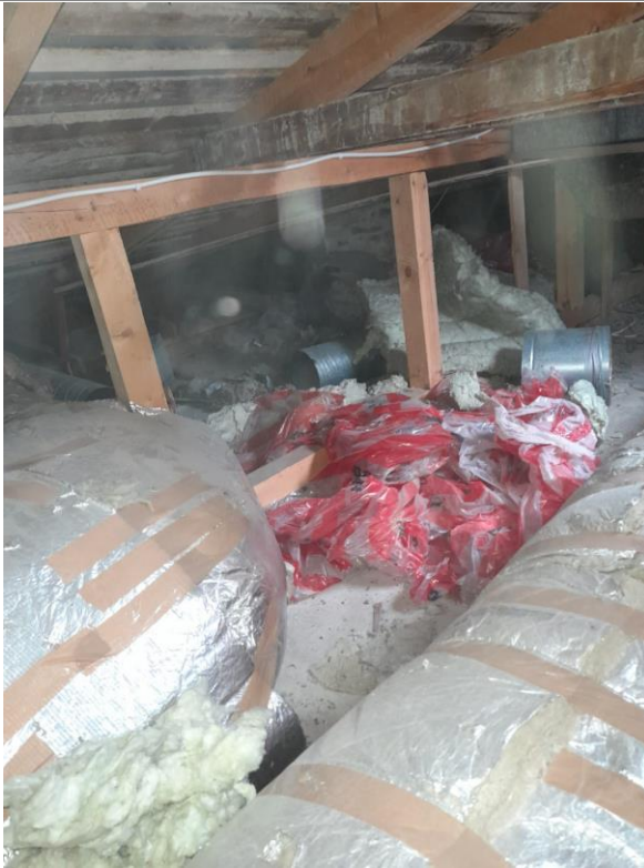
Kuva 90. Kuva liikuntasalin ullakkotilasta. Ullakkotilassa on runsaasti rakennusjätteitä. (Kuva Paavo Vainio)
