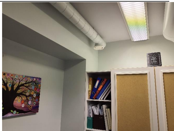
Kuva 104. Terveystieteiden tilassa 211 tilojen käyttäjät kokevat ilmanvaihdon riittämättömäksi. Tilassa on poistoilmaventtiili, mutta ei tuloilmaventtiiliä eikä muutakaan hallittua korvausilmareittiä.
