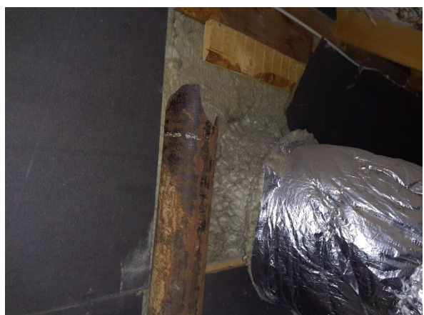
Kuva 85. Vanha viemäriputki ullakolla.
