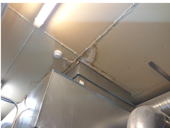
Kuva 84. Iv-koneen läpivientikohta vesikatteessa vuotaa.
