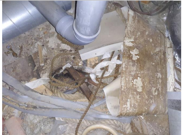
Kuva 77. Sama kohta kuin edellinen kuva. Vettä on valunut ullakkotilan lattialle.
