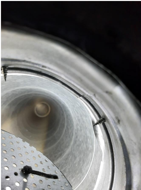
Kuva 85. Uusi puoli tuloilmakanava.
