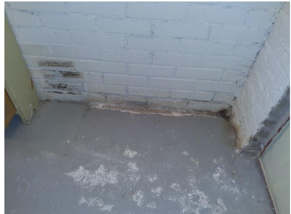
Kuva 10. Viemärivuotokohdan viereisen kirjaston arkistotilan (A) seinä- ja lattiarakenteissa todettiin kosteuden aiheuttamia vaurioita.
