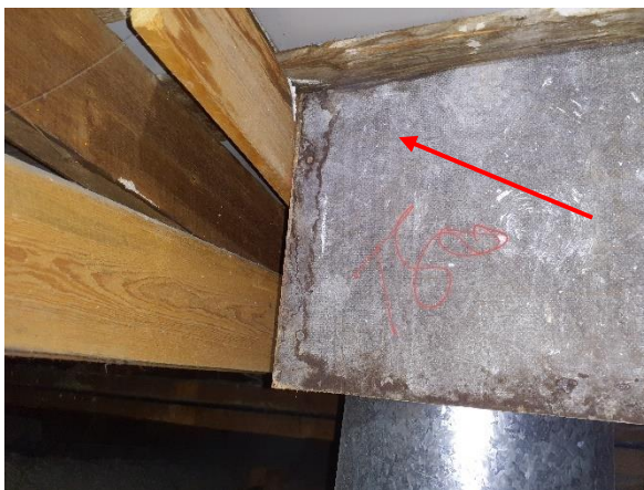
Kuva 71. Toimistuhuoneen kohdalla on vesikatteen läpivienti, jonka ympärillä olevissa rakenteissa on kosteusvaurioita.
