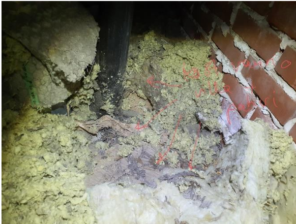
Kuva 61. Eristetilassa olevissa materiaaleissa, kuten villassa ja pahvissa on kosteuden aiheuttamia jälkiä kirjaston infopisteen kohdalla.
