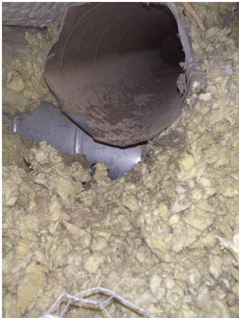
Kuva 57. Yläpohjan tuulettuvassa tilassa on avoimia vanhoja iv-kanavia.
