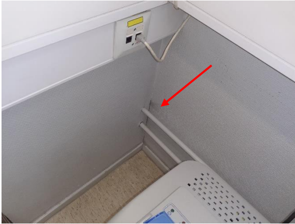
Kuva 107. Infopisteen ulkoseinärakenteen vieressä on kotelorakenne, jonka rakenneliittymässä todettu tummentuma viittaa ilmapuotoihin kotelorakenteen sisältä.
