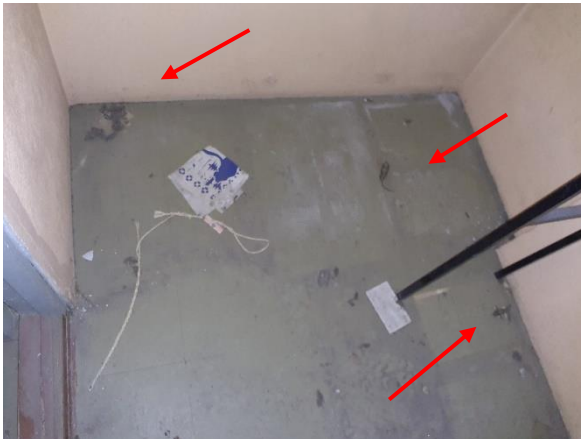
Kuva 17. Kellarissa rakennuksen länsisivun puoleisissa varastuhuoneissa oli mm. hiirien ja sammakoiden jätteitä lattialla. Pohjakuvassa tila K.
