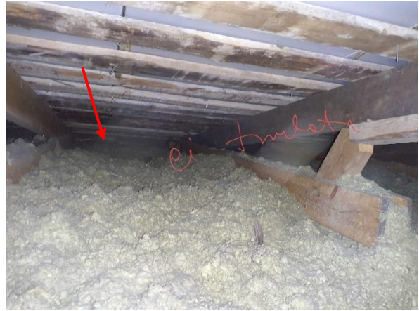
Kuva 56. Vanhan osan yläpohjarakenteen tuulettuminen on heikkoa. Räystäällä ei ole riittävä tuuletusaukkoa.
