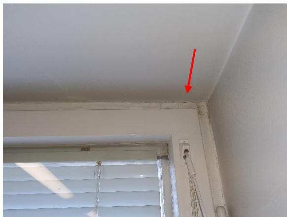
Kuva 52. Ikkuna- ja seinärakenteen liittymässä on valumajälkiä, mikä viittaa siihen, että seinärakenteen sisälle on päässyt vettä. Kuva lehtilukusalista.
