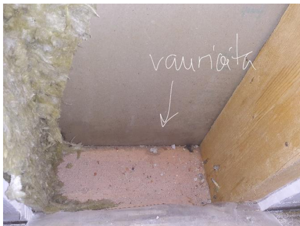
Kuva 47. Tuulensuojakipsilevyssä oli selviä vauriojälkiä ja siitä (Näyte 11, Analyysivastaus MIK9272) todettiin viite vauriosta mikrobianalyysin perusteella.
