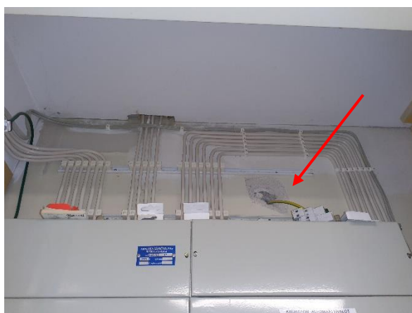
Kuva 38. Ulkoseinärakenteessa on avoimia läpivientikohtia, joiden kautta on ilmayhteys ulkoseinän eristeen ja sisäilman välillä. Kuva aulan sähkökaapista.
