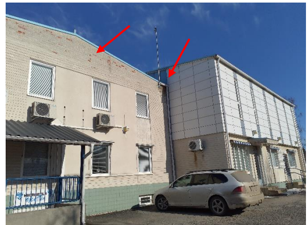
Kuva 32. Vanhan osan eteläpäädyssä yläpohjan osalla on maalipinta rapautunut tiiliverhouksessa. Uuden ja vanhan osan liittymäkohdassa katolta tulevat sadevedet aiheuttavat ylimääräistä kosteusrasitusta ulkoseinärakenteelle. Kyseisellä kohdalla on tutkimuspiste RAK4.
