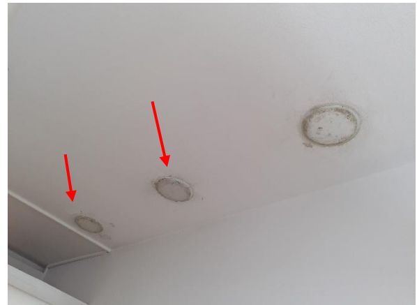
Kuva 80. Info-pisteen kohdalla tulpattuja iv-kanavia, joiden kohdalla oli paikoin ilmavirtauksen aiheuttamia tummentumia ja kosteusvaurioon viittaavaa maali- ja tasoitepinnan rapautumaa.
