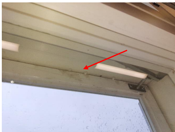
Kuva 54. Sateella uuden osan ikkunarakenteiden sisälle pääsee vettä.
