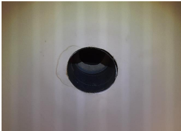
Kuva 79. Tuloilmakanavan vieressä aulan kattorakenteessa on kosteuden aiheuttamia jälkiä.
