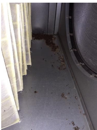
Kuva 89. Tuloilman suodatinkammiossa runsaasti epäpuhtauksia, kuten hyönteisiä.
