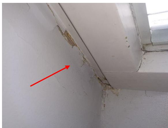
Kuva 50. Ikkuna- ja seinärakenteen liittymässä on paikoin maali- ja tasoite irronnut alustastaan. Kuva taukokuoneesta, jossa maalin ja tasoitteen (Näyte 2, MIK9275) mikrobianalyysitulokset viittaavat vaurioon.
