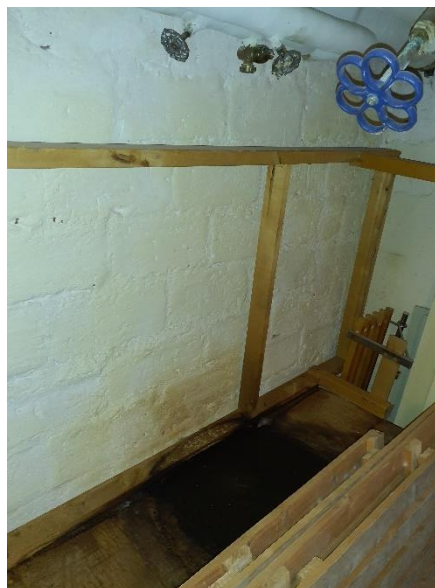
Kuva 28. Paikallinen kosteusvaurio. Vuotava venttiili. Kirjaston tiloista pohjoispäätyyn päin olevissa tiloissa.
