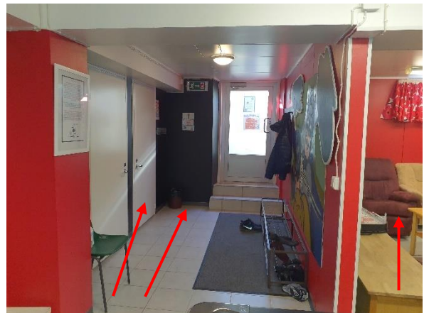
Kuva 3. Nuorisotilojen eteisessä sekä sen viereisissä tiloissa todettiin kohonneita pintakosteusarvoja lattiassa
