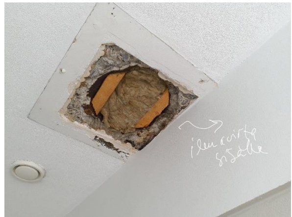
Kuva 76. Toimistohuoneen katon luukun takana on vanha läpivienti, joka oli täytetty mineraalivillalla.
