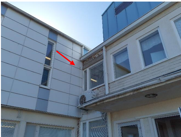
Kuva 31. Katolta tulevat sadevedet ovat aiheuttaneet ylimääräistä kosteusrasitusta ulkoseinärakenteelle uuden ja vanhan osan liittymäkohdassa.
