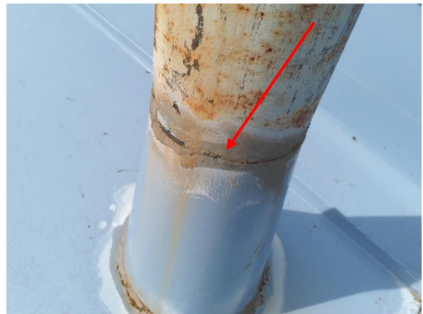
Kuva 70. Vuotokohta viemäriputken ja vesikatteen läpivientikappaleessa.
