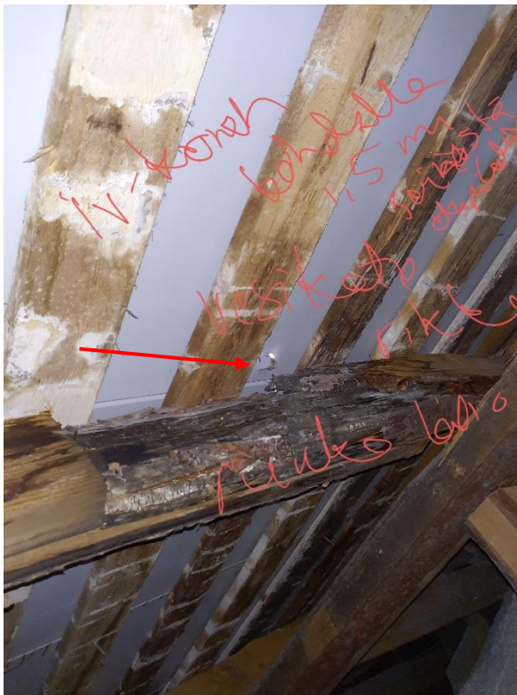
Kuva 65. Vesikatteessa on reikä ja sen kohdalla vesikatteeseen runko on lahovaurioitunut lastenosaston kohdalla.
