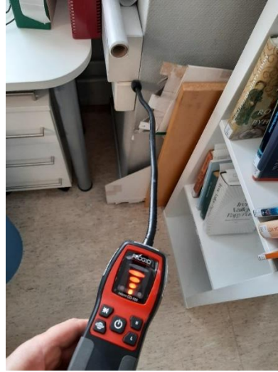
Kuva 16. Nuorisotilan wc:n kotelorakenteeseen laskettu kaasu tuli nopeasti kirjaston 2. -kerroksen infopisteen kotelorakenteen kautta sisäilmaan.
