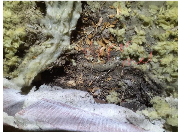
Kuva 62. Eristetilassa on herkästi kosteuden vaikutuksesta vaurioituvaa orgaanista materiaalia. Kuva kirjaston infopisteen kohdalta.
