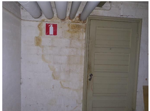
Kuva 26. Paikallinen kosteusvaurio. Kirjaston tiloista pohjoispäättyyn päin olevissa tiloissa.
