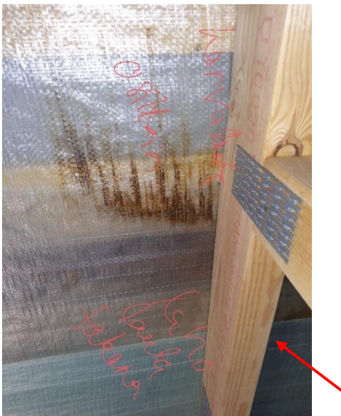
Kuva 83. Vesikatteen aluslaudoituksessa oli paikoin lahovaurioita.
