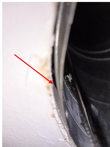
Kuva 84. Tuloilmakanavan ja kattorakenteen liittymä on epätiivis.
