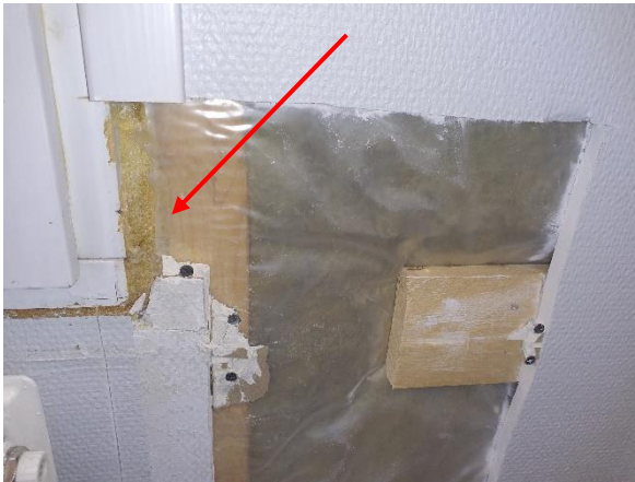
Kuva 41. Höyrinsulkua ei ole asennettu tiiviisti.
