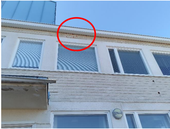
Kuva 33. Rakennuksen itäisivulla toimistihuoneen kohdalla on kosteusvaurioon viittaavaa maalin rapautumista tiiliverhouksessa.
