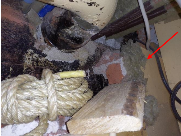
Kuva 14. Nuorisotilan komerossa on avoin seinärakenne, jossa seinän tiiliverhouksen sisäpinnalla on mineraalivillaeriste ja lastulevyverhous.
