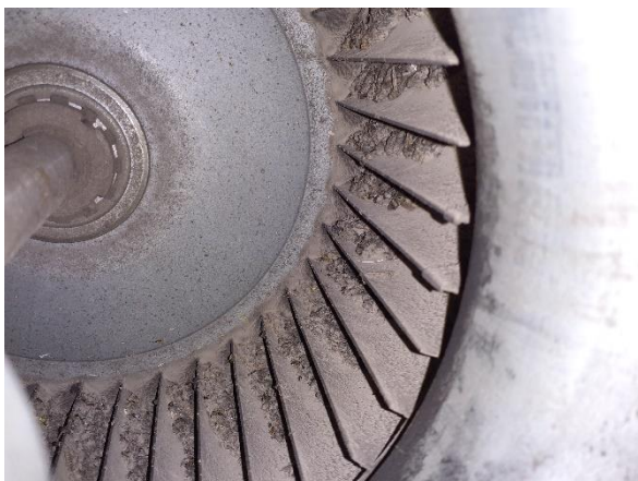
Kuva 87. Poistopuhallin on likainen.
