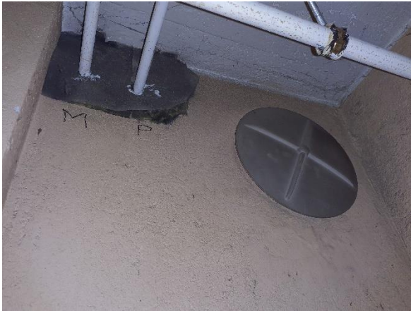
Kuva 19. Sama tila kuin edellinen kuva. Tilassa on korvausilmaventtiili.
