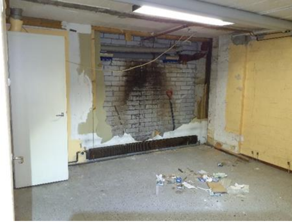
Kuva 7. Kellarissa kirjaston arkistotilan vieressä on n. 3 vuotta sitten tapahtunut viemärivuoto. Kuvassa näkyvässä tilassa oli lattian pintakosteusarvot koholla ja lattiassa on muovi- ja muovilaattapinnoite.
