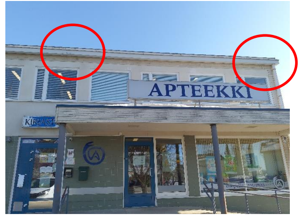
Kuva 34. Rakennuksen länsisivulla on kosteusvaurioon viittaavaa tummentumaa ja halkeamia tiiliverhouksessa.
