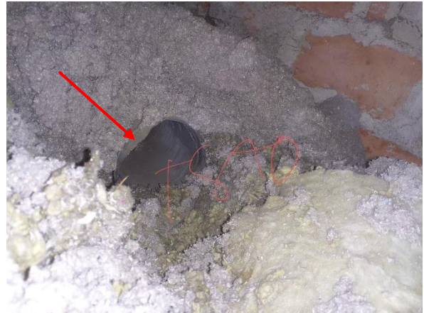
Kuva 74. Avoimia iv-putkia oli useita eri puolilla yläpohjan tuuletettavaa tilaa. Kuva toimistohuoneen kohdalta.
