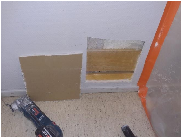
Kuva 105. Infopisteen keskiosalla on hormirakenne, joka on verhoitu kipsilevyllä. Hormirakenteen pinta oli kylmä, kun ulkona oli kylmä.
