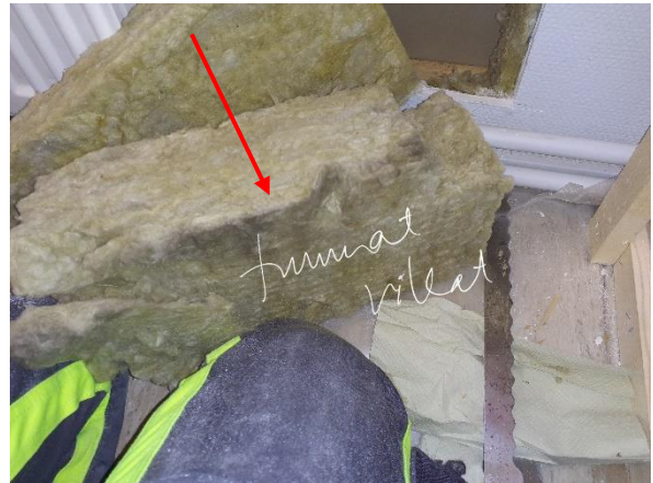
Kuva 42. Ulkoseinän mineraalivillaeristeessä on tummentumaa, mikä on merkki ilman kulkeutumisesta ulkoseinän kautta. Mineraalivillassa (Näyte 3, Analyysivastaus MIK9272) todettiin viite vauriosta mikrobialyysin perusteella.
