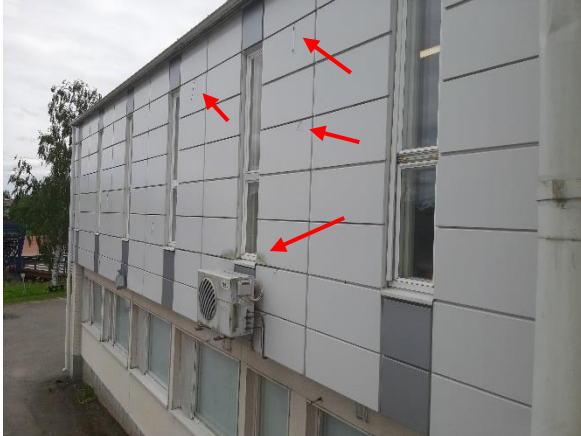
Kuva 29. Uuden osan ulkoverhouksena olevan peltikasetin liitoksista roikkuu todennäköisesti tiivistenauhoja. Ilmalämpöpumpun päältä roiskuu vettä seinään. Tutkimuspiste RAK3 sijaitsee ilmalämpöpumpun kohdalla.
