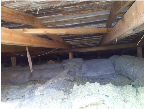
Kuva 55. Vahan osan yläpohjan tuulettuvassa tilassa on aistittavissa kosteusvaurioon viittaavaa hajua. Vesikatteessa ei ole aluskatetta.
