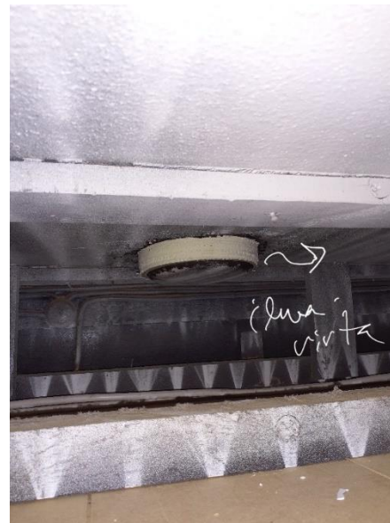
Kuva 78. Lasten osaston kohdalla lasketun katon yläpuolella on tiivistetyt vanhat ilmanvaihtokanavat. Kanavan läpivientikohdasta havaittiin savukokeella ilmavirtausta huonetilaan päin.
