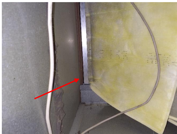
Kuva 90. Suodatinkehys ja tiivisteen välistä tapahtuu ohivirtausta.
