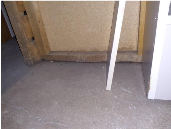
Kuva 23. Väliseinärakenteen alaosassa on kosteuden aiheuttamia vaurioita. Tila H.
