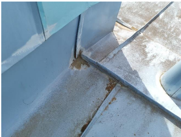
Kuva 69. Sama kohta kuin edellinen kuva. Vuotokohta Vesikatteen saumakohdissa.
