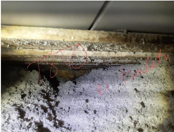
Kuva 73. Toimistohuoneen kohdalla paikoin yläpohjan eristeet ovat kiinni vesikatteessa. Rakenne ei tuuletu.
