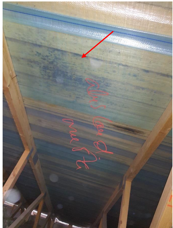
Kuva 82. Vesikatteen alla on paikoin umpilaudoitu ja siinä oli nähtävissä kosteuden aiheuttamia vaurioita.
