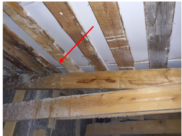
Kuva 68. Sama kohta kuin edellinen kuva. Vaurioita vesikatteen puurakenteissa.
