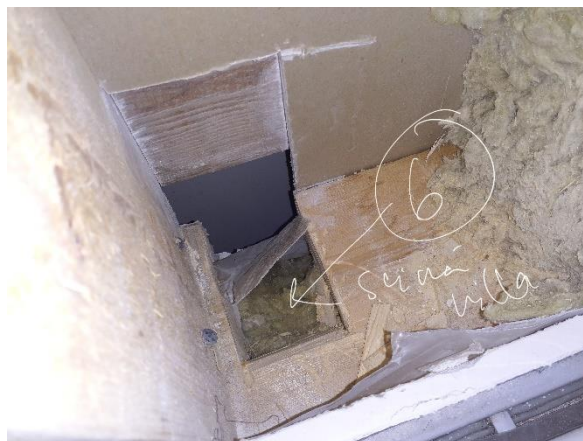
Kuva 44. Vaakarunkopuun alla on muovi, jonka alla on mineraalivillaeriste, jossa todettiin viite vauriosta mikrobianalyysin perusteella (Näyte 6, Analyysivastaus MIK9272).
