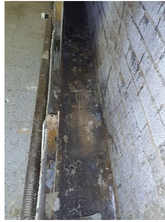
Kuva 8. Viemärivuodon jäljiltä on viemärijätettä vielä rakenteiden pinnalla. Viemäri vahingon vauriot ovat korjaamatta.
