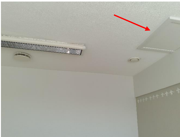
Kuva 75. Toimistohuoneen katossa on luukku, jonka takaa havaittiin ilmavirtausta huonetilaan päin.
