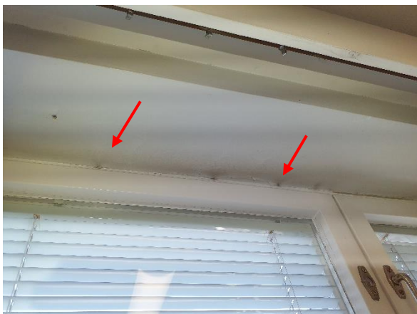
Kuva 51. Vanhan osan ikkuna- ja seinärakenteiden liittymässä on paikoin tummentumaa, mikä viittaa ilman kulkeutumiseen rakenteen kautta sisätiloihin. Kuva lehtilukusalista.
