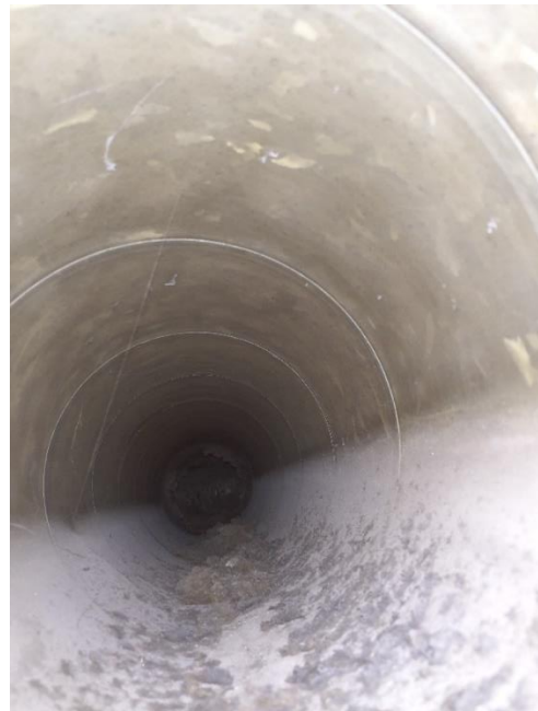
Kuva 58. Vanhan kanavan sisällä on epäpuhtauksia kuten mineraalivillaa.
