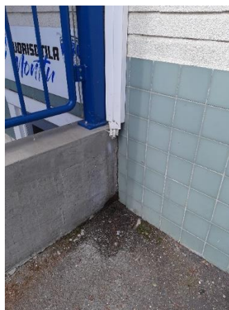
Kuva 110. Ilmalämpöpumppujen poistovesi valuu nuorisotilan sisäänkäynnin vieressä maahan.
