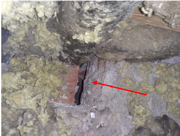
Kuva 63. Viemärin tuuletusputken läpivienti yläpohjarakenteessa epätiivis kirjaston infopisteen kohdalla.
