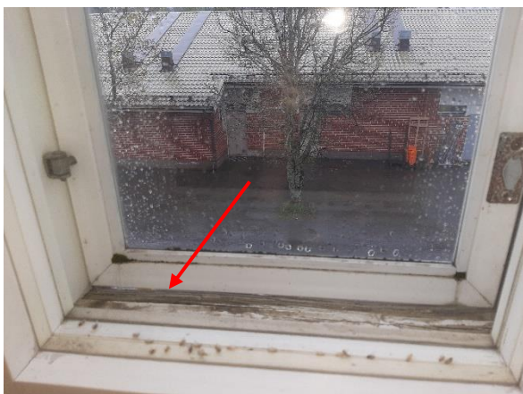
Kuva 53. Uuden osan ikkunarakenteiden sisälle pääsee sadevesi ja ikkunarakenteissa on kosteuden aiheuttamia vaurioita.
