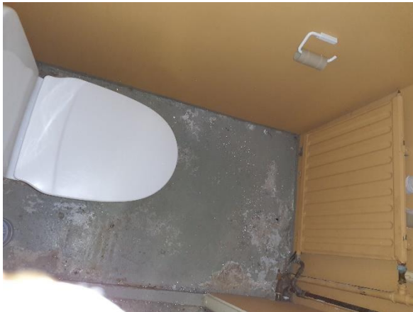
Kuva 9. Viemärivuotokohdan vieressä on wc-tila (S), jossa lattian pintakosteusarvot ovat koholla ja lattian maalipinnoite on rapautunut.
