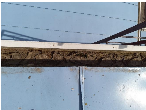
Kuva 109. Räystäskourut ovat likaiset.
