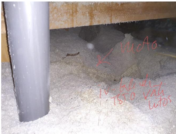
Kuva 67. Iv-konehuoneen ja toimistuhuoneen välisellä alueella vesivuotojälkiä eristeiden päällä.
