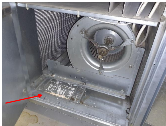
Kuva 88. Tuloilman puhallinkammiossa on valkeita rakeita pohjalla. Rakeiden alkuperä ei tiedossa.
