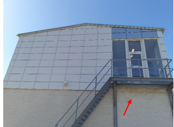
Kuva 30. Kirjaston uuden osan porrastasanteen kohdalla kosteuden aiheuttamia jälkiä tiiliverhouksessa.
