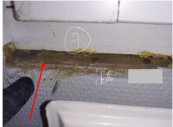
Kuva 40. Ikkunan alla on sekä villaa, että uretaanivaahtoa. Mineraalivillassa (Näyte 7, Analyysivastaus MIK9272) todettiin viite vauriosta mikrobialyysin perusteella. Höyrinsulkumuovia ei ole asennettu tiiviisti.
