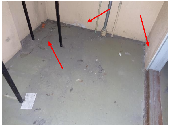
Kuva 18. Sama tila kuin edellinen kuva. Kosteuden aiheuttamia jälkiä lattiassa, jossa muovi-laattapinnoite. Seinän alaosassa on kosteusvaurioon viittaavaa maalin rapautumista. Rakenteissa ei todettu tutkimushetkellä poikkeavia pintakosteusarvoja.
