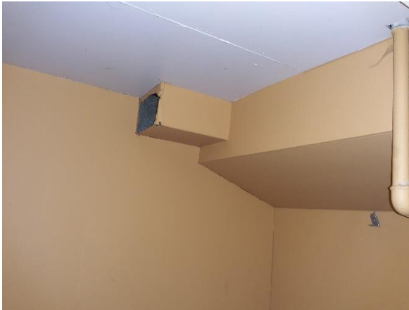
Kuva 11. Viemärivuotokohdan viereisessä wc-tilassa (S) on avoimia vanhoja iv-kanavia. Tilasta todettiin olevan ilmayhteys 2. -kerroksen kirjastotiloihin merkkiainekokeen avulla.
