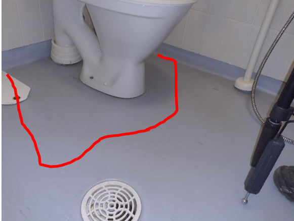
Kuva 102. 2. -kerroksen wc:n (wc1) lattiassa on pintakosteusarvot koholla ja matto irti alustastaan wc-istuimen ympärillä.
