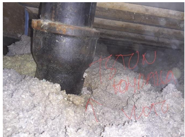
Kuva 72. Toimistuhuoneen kohdalla on viemärin tuuletusputki, jonka kohdalla on vesivuotojälkiä eristeissä.
