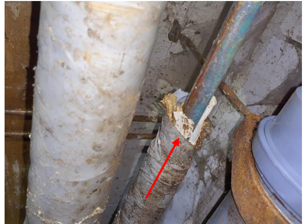
Kuva 24. Putkieristeissä on todennäköisesti asbestia.
