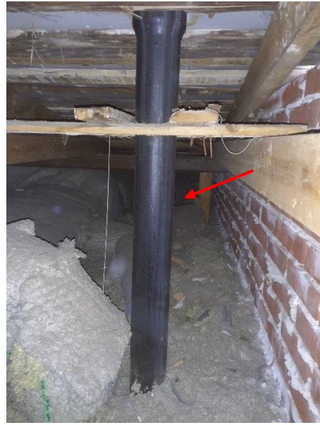
Kuva 60. Valumajälkiä viemärin tuuletusputken ulkopinnalla kirjaston infopisteen kohdalla.
