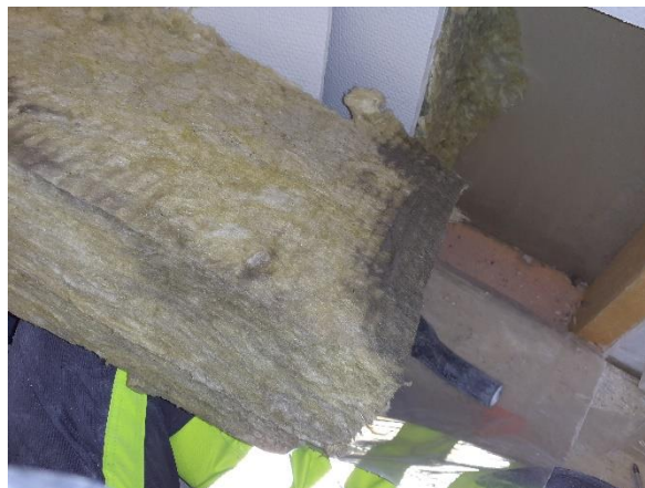
Kuva 46. Ulkoseinän mineraalivillaeristeessä on tummentumaa, mikä on merkki ilman kulkeutumisesta ulkoseinän kautta. Mineraalivillassa (Näyte 8, Analyysivastaus MIK9272) todettiin viite vauriosta mikrobianalyysin perusteella.
