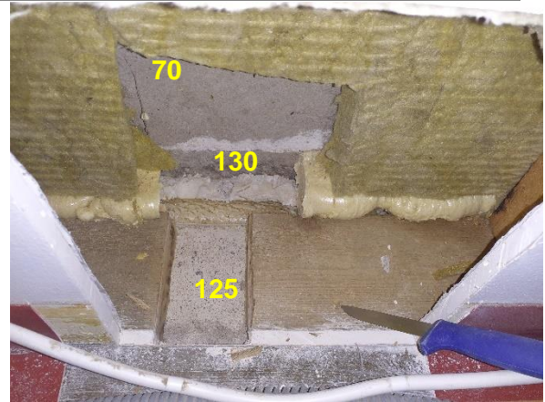
Kuva 64. Sokkelin ulkokuori ja alasidepuun alla oleva betoni ovat märkiä.
