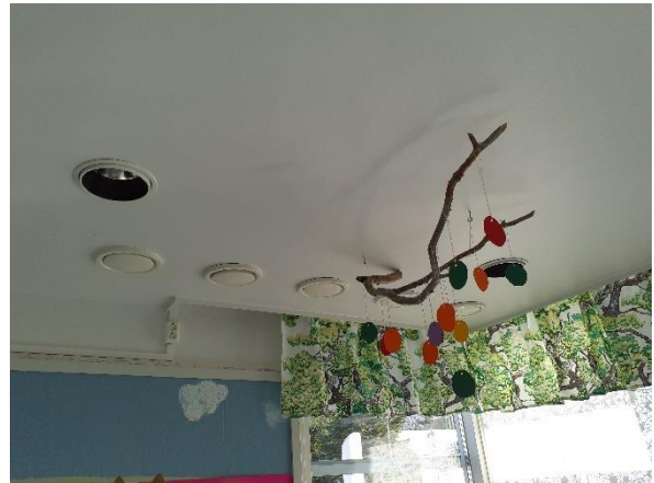
Kuva 110. Oravanpesän oleskelutilassa A145 on poistoilmaventtiilit. Tuloilmaventtiilit sijaitsevat tilaan johtavilla käytävillä.
