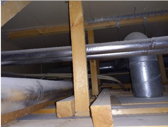
Kuva 89. Myyränmajan käytävällä C138 on alakatto, jonka yläpuolella kulkee lvis-tekniikkaa. Alakaton yläpuolisilla pinoilla on runsasta pölykertymää.
