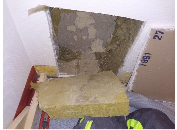
Kuva 47. Tuulensuojalevyn takapinnalla on tummentumaa. Tuulensuojalevyssä (Näyte 7, MIK9231) todettiin heikko viite vauriosta mikrobianalyysin perusteella.
