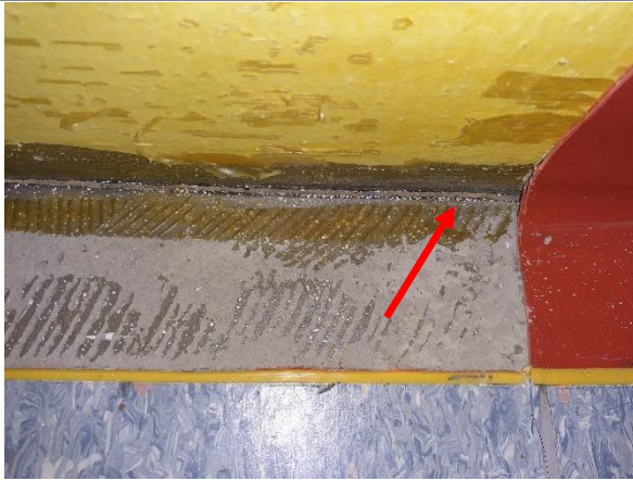
Kuva 53. Lattia- ja seinärakenteen liittymässä on rako.
