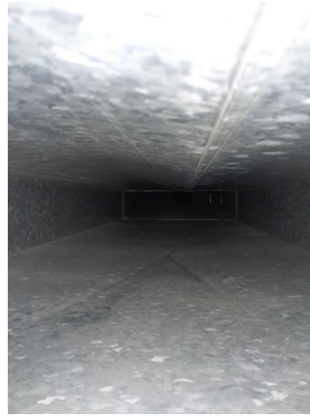
Kuva 112. Aulan tuloilmakanava tutkimuspisteessä IV3. Kanavan pohjalla on pölykertymää.
