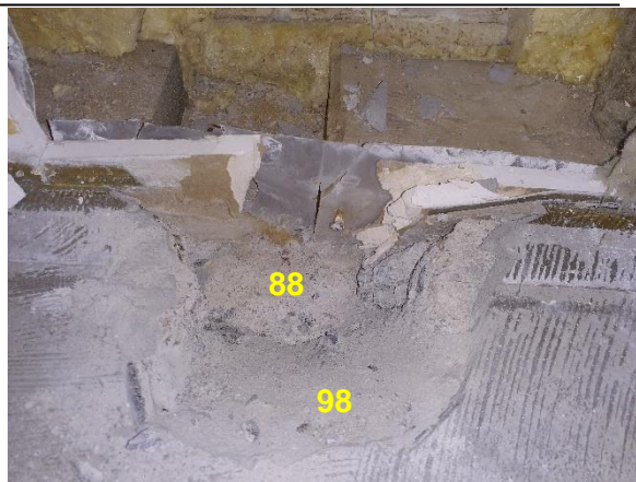
Kuva 29. Alapohjarakenteen kosteus on koholla syvemmällä rakenteessa pintakosteusmittauksen perusteella.
