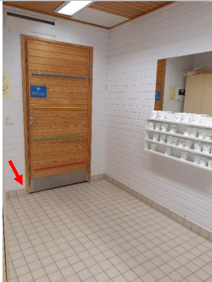
Kuva 105. Pukuhuone A108. Kosteusvauriojälkiä ovi- ja seinärakenteissa.
