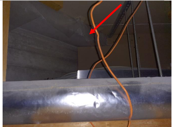
Kuva 90. Yläpohjan höyrnsulkumuovia ei ole asennettu tiiviisti. Myyränmajan käytävä C138
