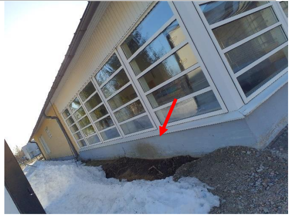
Kuva 7. Jäljet sokkelissa viittaa siihen, että räystäskouru on tiputtanut vettä ko kohdassa maahan.
