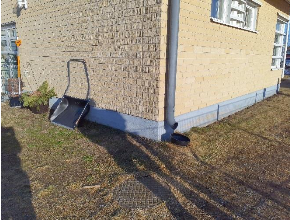
Kuva 2. Paikoin syöksytorvien alla on rännikaivot. Päiväkodin tilojen alueella rakennuksen vierellä on pääosin nurmi tai multatyypinen maa-aines sokkelissa kiinni. Maanpinta ei vietä rakennuksesta pois päin.
