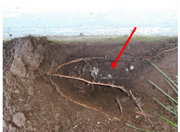
Kuva 11. Pystyeriste sokkeliä vasten n. 20 cm syvyydeltä alkaa. Maa-aines multaa. Runsaasti kasvillisuuden juuria rakennuksen vierustäytössä rakennuksen pohjoisivulla.
