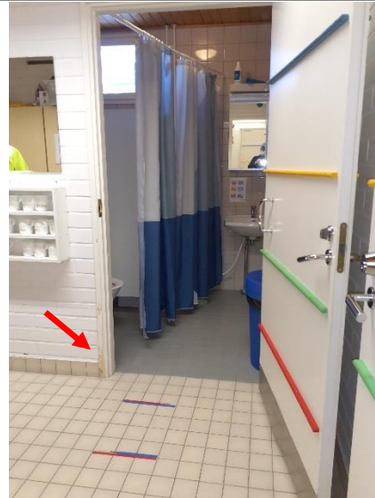
Kuva 106. Pukuhuone A108. Kosteusvauriojälkiä ovi- ja seinärakenteissa.
