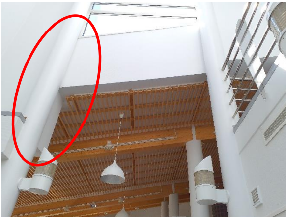
Kuva 91. Kosteusvauriojälkiä korjattu juhlasalin 133 rakenteissa.
