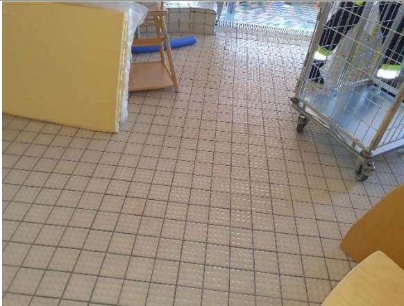
Kuva 99. Allasosaston lattia pintakosteusarvot: 75-116.
