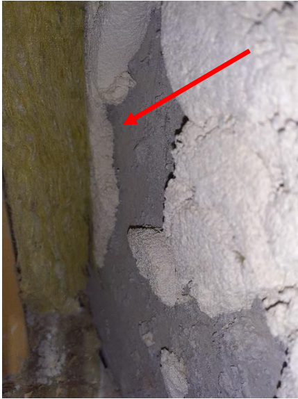
Kuva 50. Ulkoseinän alaosan tuulettuminen on puutteellista, kun tuulensuojalevy on kiinni muurauslaastissa, mikä on muuratessa tippunut tuulensuojalevyn ja sokkelin ulkokuoren väliin.
