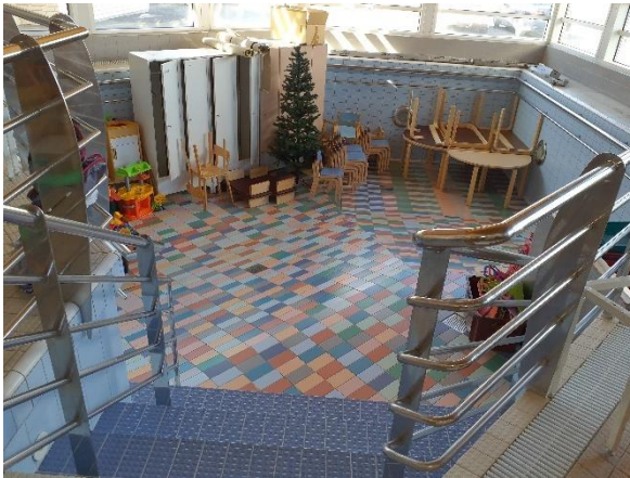
Kuva 97. Altaan seinän pintakosteusarvot: 78-90, altaan pohjan pintakosteusarvot: 86-108.
