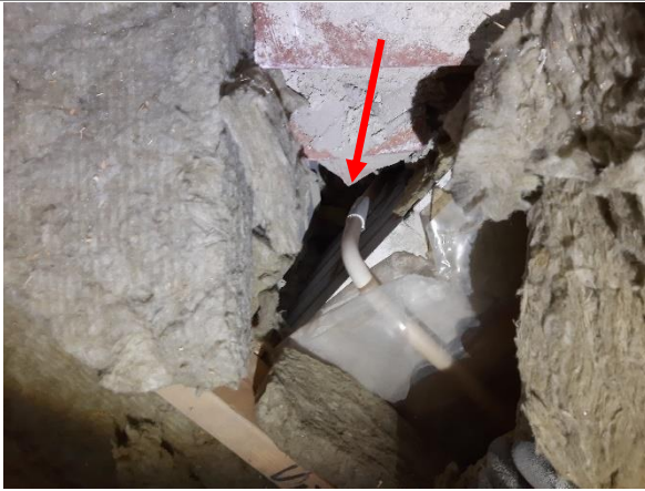
Kuva 75. Avoin yhteys yläpohjarakenteesta muurattuun kotelorakenteeseen Oravanpesän keittiötilan (C152) kohdalla. Merkittävä epätiivelyskohta yläpohjan höyrynsulussa.
