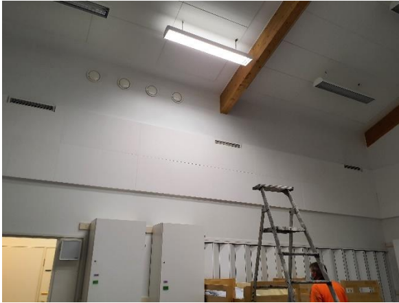
Kuva 107. Isossa lepotilassa A116 tulo- ja poistoilmapäätelaitteet sijaitsevat samalla seinällä korkean huoneen yläosassa.
