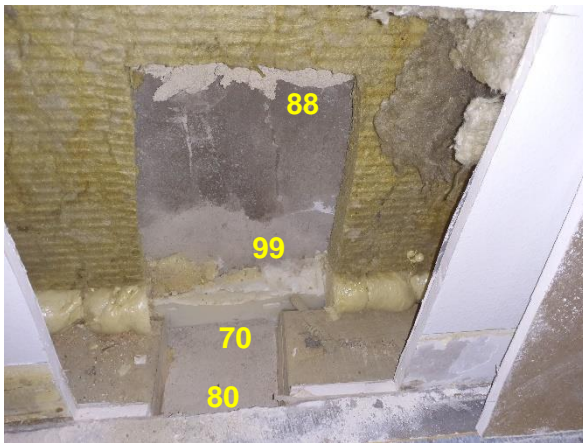
Kuva 41. Sokkelin ulkokuori on märkä erityisesti alaosaan.
