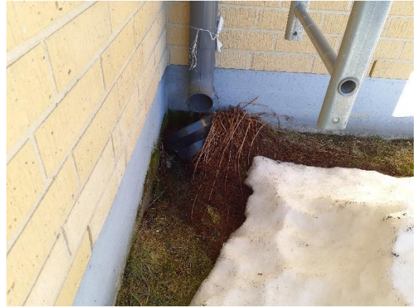
Kuva 3. Rännikaivo on pois paikoiltaan Oravanpesän keittiön C152 kohdalla. Sammaloituminen sokkelipinnassa viittaa siihen, että sokkeliin on aiheutunut pitkäaikaista ylimääräistä kosteusrasitusta.
