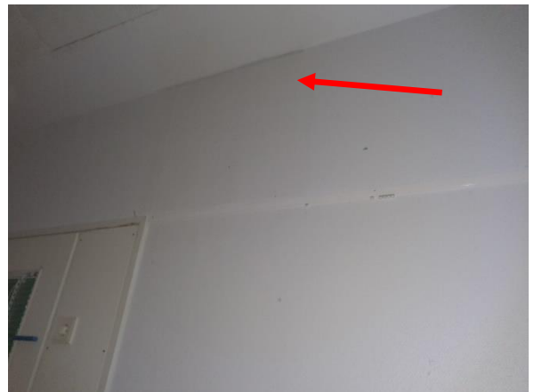
Kuva 88. Käytävän seinärakenteessa pienryhmätilan A112 kohdalla on jälkien perusteella korjattu kosteusjälkiä.
