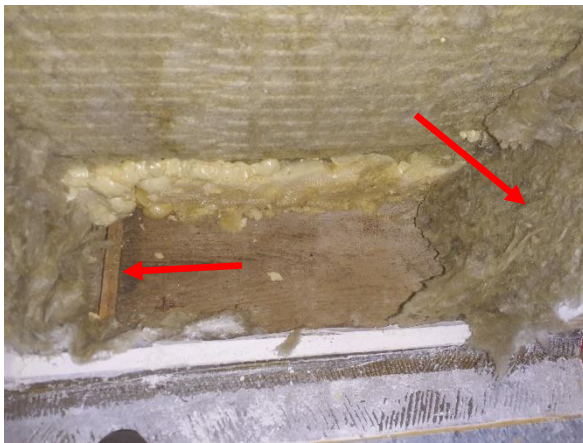
Kuva 55. Ulkoseinän eristeessä (Näyte 1, MIK9236) ei todettu viitettä vauriosta mikrobialyysin perusteella. Alasidempuun jatkoskohdassa on puukappale, joka ei ole kestopuuta. Siinä todettiin mikrobialyysin perusteella viite vauriosta (Näyte 4, MIK9236).
