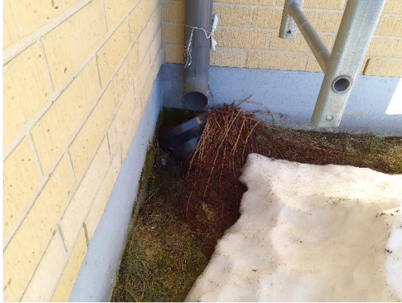
Kuva 60. Tutkimuspisteen kohdalla syöksytyrven alla rännikaivo on ollut pois paikoiltaan.
