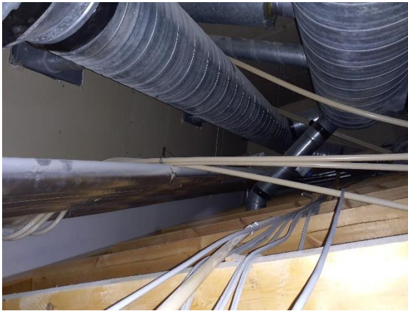
Kuva 85. Ketunkolon käytävällä A115 on laskettu katto, jonka yläpuolella on lvis-tekniikkaa.
