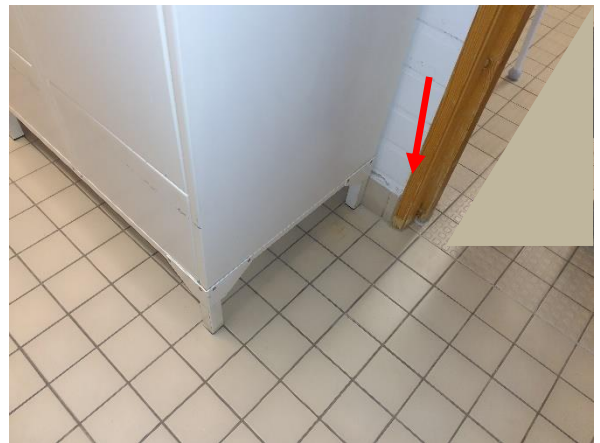
Kuva 102. Pukuhuone A110. Kosteusvauriojälkiä ovi- ja seinärakenteissa.
