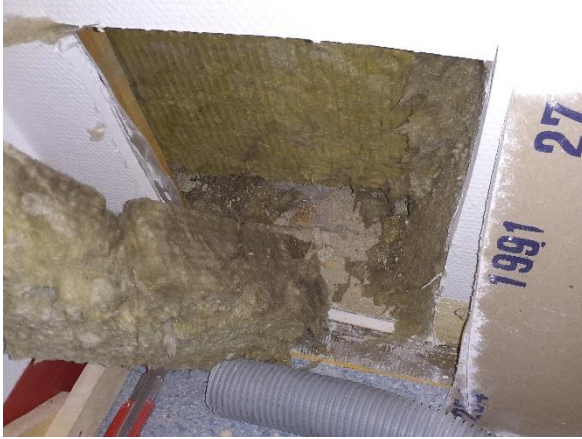
Kuva 46. Seinän alaosassa tuulensuojalevy on korvattu pehmeällä mineraalivillalla, jossa todettiin heikko viite vauriosta mikrobianalyysin (Näyte 5, MIK9231) perusteella.
