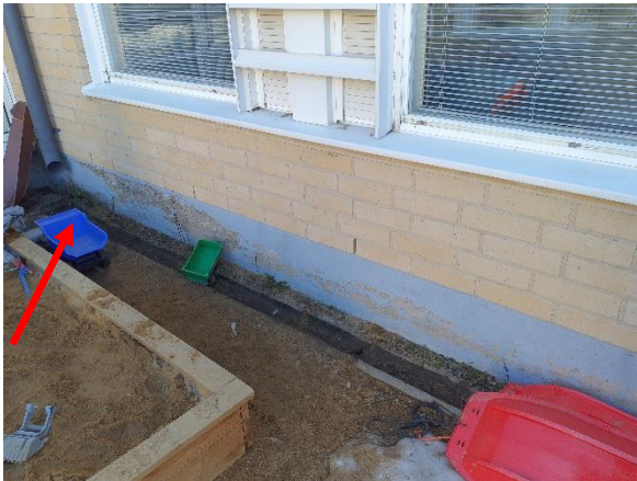
Kuva 51. Tutkimuspisteen kohdalla on syöksytorni, josta vesi johtuu betonikouruun. Syöksytornesta tullut vesi on aiheuttanut kosteusvaurioita myös sokkelirakenteelle.
