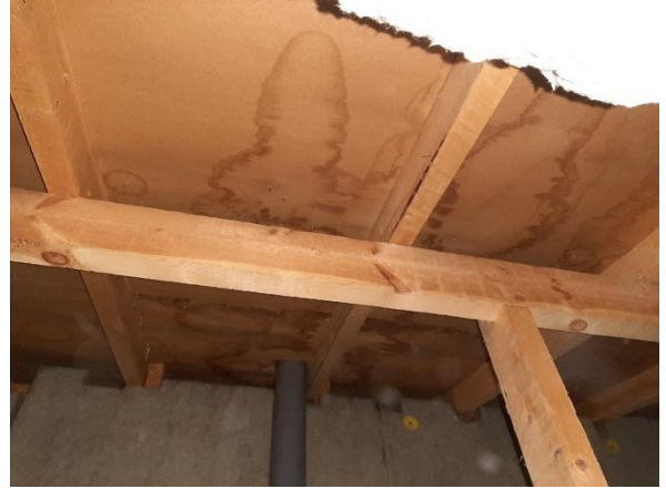
Kuva 84. Paikoin vanha vesikatto on vuotanut keittiön kohdalla.
