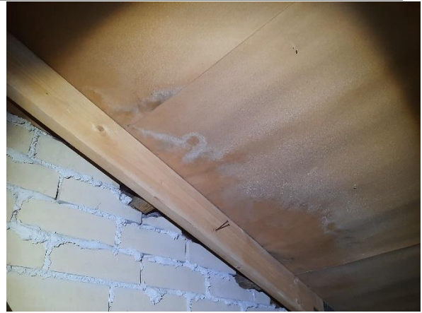
Kuva 76. Kosteusvauriojälkiä Oravanpesän vesikattorakenteen ja ulkoseinärakenteen liittymässä.
