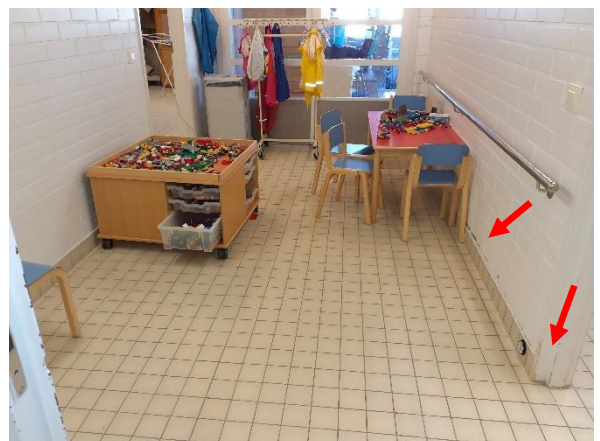
Kuva 104. Eteinen A109. Kosteusvauriojälkiä ovi- ja seinärakenteissa.
