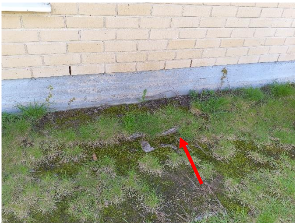
Kuva 10. Isoja kasvillisuuden juuria vierustäytössä rakennuksen pohjoisivulla. Jäljet sokkelissa viittaa siihen, että räystäskouru on tiputtanut vettä ko kohdassa maahan.
