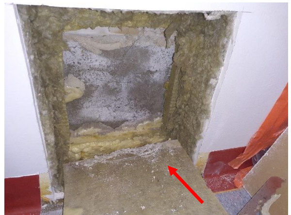
Kuva 56. Ulkoseinän tuulensuojalevyssä (Näyte 2, MIK9236) todettiin viite vauriosta mikrobialyysin perusteella.
