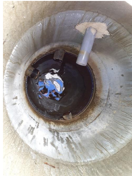
Kuva 15. Yhteen salaojakaivoon on johdettu harmaa putki, jonka tarkoitus ei tullut tutkimuksessa selville.
