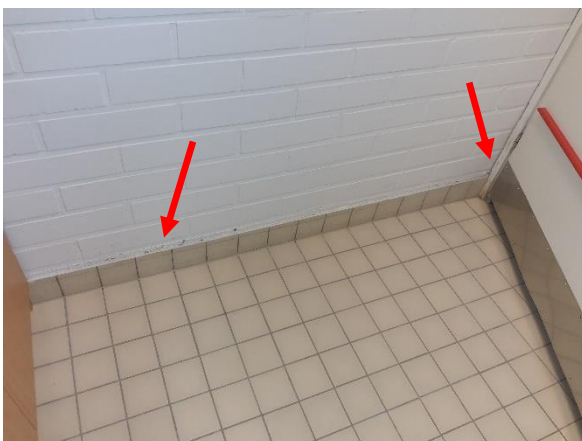
Kuva 103. Pukuhuone A110. Kosteusvauriojälkiä ovi- ja seinärakenteissa.
