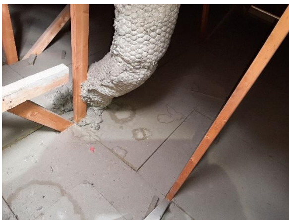
Kuva 67. Paikoin kosteuden aiheuttamia jälkiä eristeiden päällä. Kuva Oravanpesän kohdalla.
