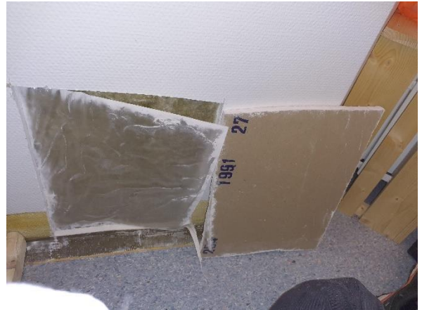
Kuva 45. Kipsilevyn takapinnalla ei ole havaittavissa selviä kosteuden aiheuttamia vaurioita.
