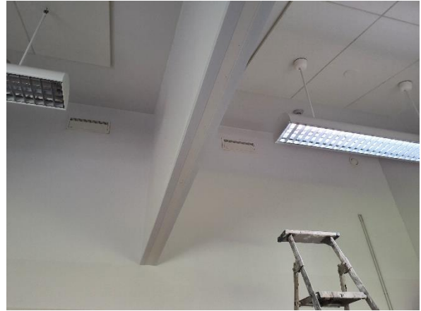
Kuva 108. Ryhmätilassa A113 ja A114 tulo- ja poistoilmapäätelaitteet sijaitsevat samalla seinällä korkean huoneen yläosassa.
