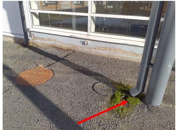
Kuva 5. Syöksytorven alla ei ole rännikaivoa.
