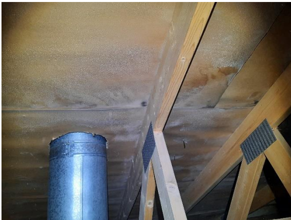
Kuva 73. Kosteusvaurioita aluskatteessa Oravanpesän keittiötilan (C152) kohdalla piipun läheisyydessä.
