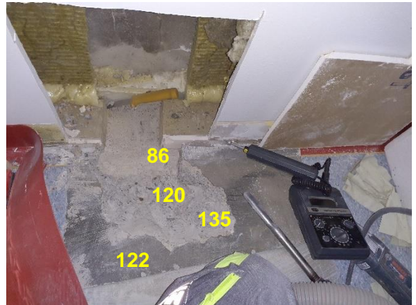
Kuva 27. Lattian betonirakenteen kosteus on korkea pinta-kosteusmittauksen perusteella.
