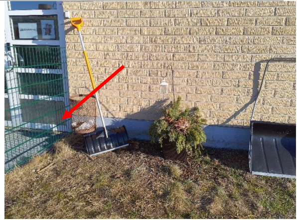
Kuva 13. Maanpinta on lattiapinnan kanssa lähes samalla tasolla.
