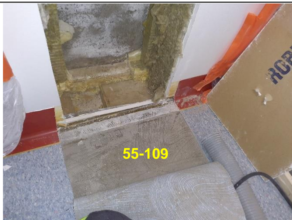
Kuva 28. Muovimaton alla betonirakenteen pinnan kosteus on paikoin korkea pintakosteusmittauksen perusteella.
