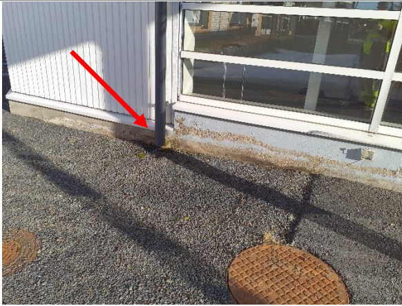
Kuva 6. Syöksytorven alla ei ole rännikaivoa.
