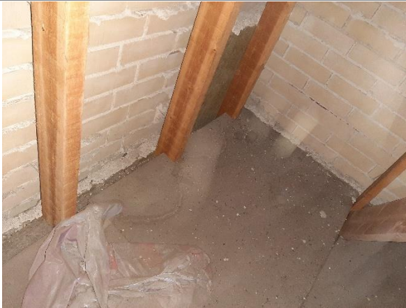
Kuva 71. Kosteusvauriojälkiä yläpohjan eristeiden päällä ulkoseinän läheisyydessä. Kuva Oravanpesän lepotilan C148 kohdalta.
