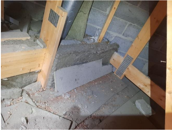
Kuva 77. Puiden lehtiä yms. ulkoa tullutta roskaa yläpohjan eristeiden päällä. Kuva Oravanpesän ja aulan C144 liittymäkohdasta.
