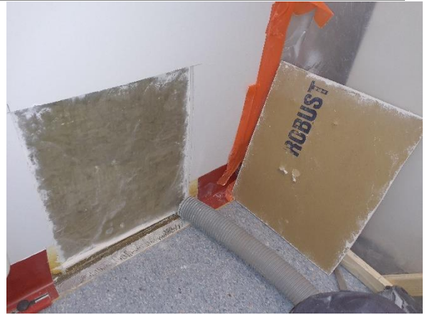
Kuva 54. Kipsilevyn takapinnalla ei näy viitteitä kosteusvaurioista.
