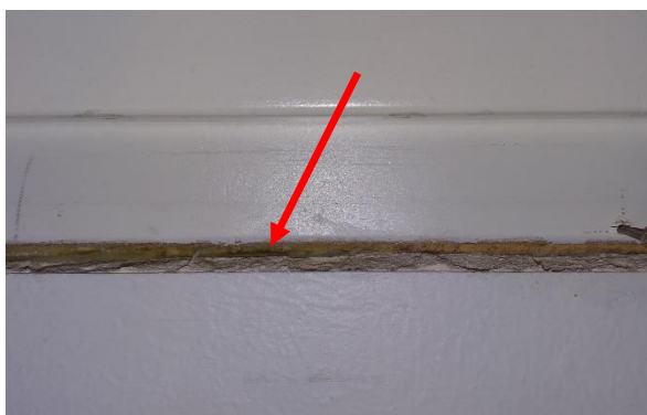
Kuva 30. A112. Höyrynsulkua ei ole asennettu tiiviisti ikkunarakenteeseen.
