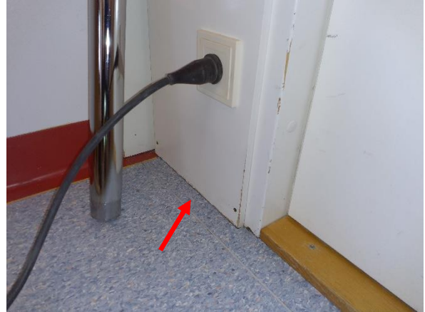
Kuva 128. Oven vieressä rakenteessa kosteuden aiheuttamia vaurioita Ketunkolon pienryhmätalassa A112.
