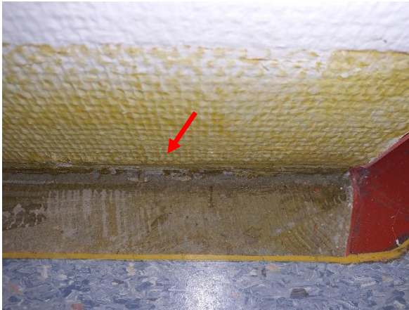
Kuva 44. Rakenneliittymä on epätiivis
