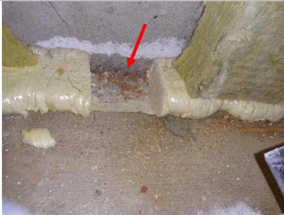
Kuva 63. Puulastuja sokkelin betonirakennetta vasten. Puulastussa todettiin viite vauriosta mikrobianalyysin perusteella (Näyte 9, MIK9236).
