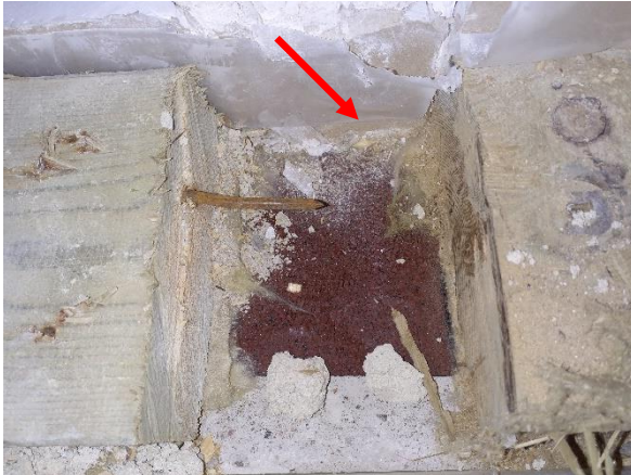
Kuva 48. Alasidepuun alla on mineraalivilla ja sen alla huopakasta. Mineraalivillassa (Näyte 6, MIK9231) todettiin heikko viite vauriosta mikrobianalyysin perusteella. Höyrynsulkumuovin alareuna päättyy alasidepuun alareunan tasolle.
