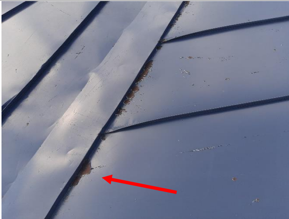
Kuva 93. Vesikatteen pinnoite on paikoin huonossa kunnossa.
