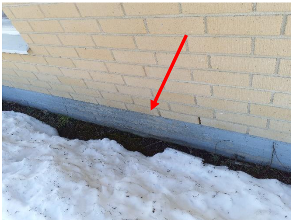
Kuva 33. Tutkimuspisteen kohdalla on sokkelirakenteen ulkopinnalla kosteuden aiheuttamia jälkiä.
