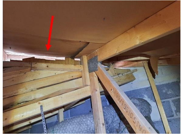
Kuva 78. Eri tasolla olevien vesikatteen osien liitoskohdista pääsee ulkoa puiden lehtiä yms. yläpohjan ullakotilaan. Kuva Oravanpesän ja aulan C144 liittymäkohdasta.
