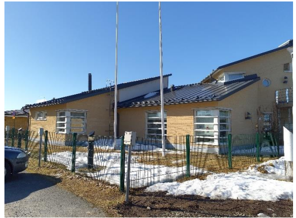
Kuva 9. Maanpinta ei pääosin vietä selvästi rakennuksesta pois päin.
