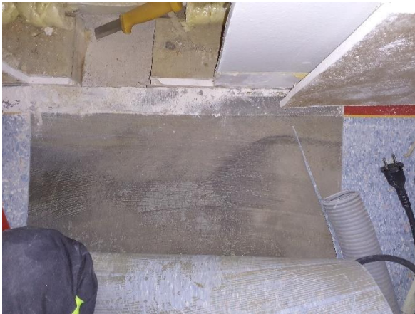
Kuva 26. Lattiapinnoitteen alapuolisessa rakenteessa on materiaalien kosteusvaurioitumiseen viittaavaa tummentumaa.
