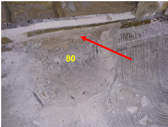
Kuva 59. Seinän sisäverhouslevy on kiinni alapohjan betonilaatassa. Kipsilevyssä todettiin mikrobianalyysin perusteella heikko viite vauriosta (Näyte 5, MIK9236). Betonirakenne on kostea kipsilevyn alareunan tasolla.
