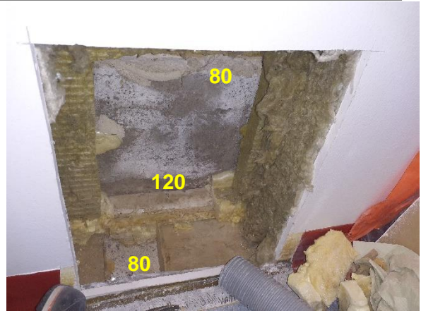
Kuva 58. Sokkeli on märkä erityisesti alaosastaan. Alasidepuun alla oleva betoni on kostea.
