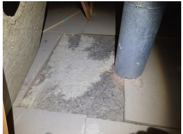
Kuva 74. Runsasta tummentumaa yläpohjan eristeissä Oravanpesän keittiötilan (C152) kohdalla piipun läheisyydessä.
