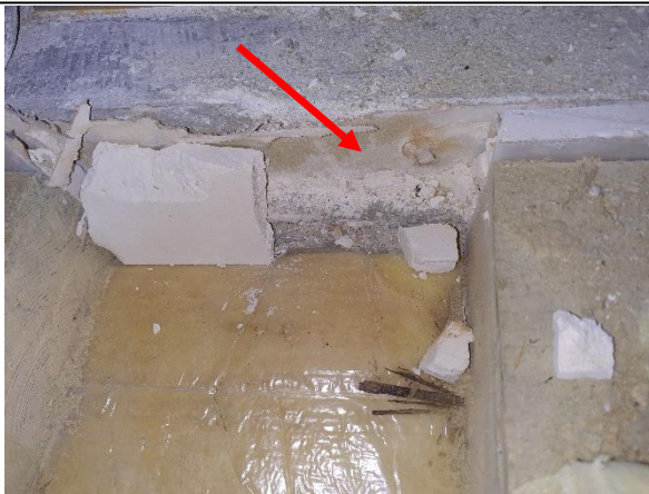
Kuva 39. Lattian pintabetoni on kiinni seinän kipsilevyssä.
