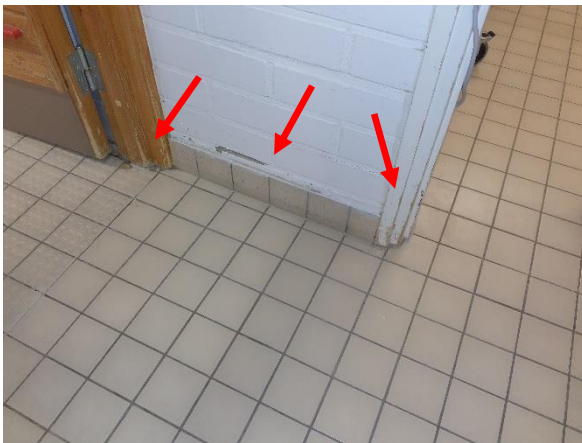
Kuva 101. Pukuhuone A110. Kosteusvauriojälkiä ovi- ja seinärakenteissa.
