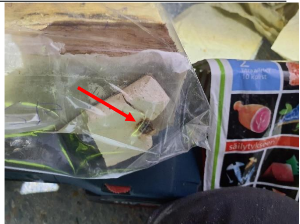
Kuva 40. Seinän kipsilevyn ruuvissa on kosteuden aiheuttamia vaurioita.
