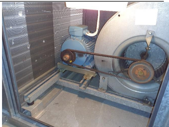
Kuva 114. Päiväkodin tilojen tuloilmakoneen puhallinkammion pohjalla on hyönteisiä.
