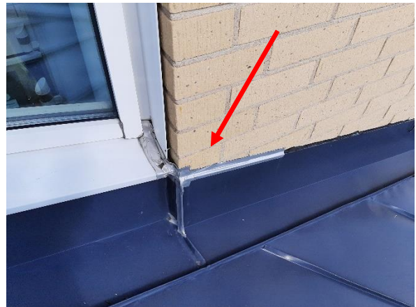
Kuva 92. Ikkuna-, seinä- ja kattorakenteiden liittymä on vuotanut juhlasalin 133 kohdalla.
