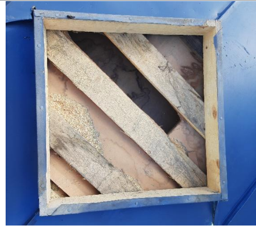
Kuva 94. Myyränmajan ja Ketunkolon välisen käytävän kohdalla on luukku vesikatteessa. Siitä ei ole kuitenkaan käyntiä ullakotilaan. Rakenteissa kosteusvauriojälkiä.
