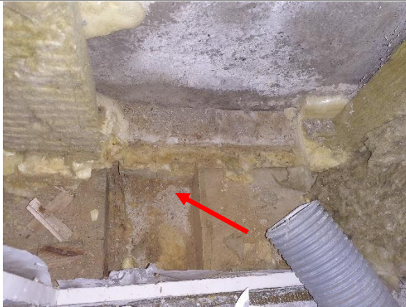
Kuva 57. Purua sokkelin betonirakenteen päällä. Alasidepuun ja betonin välissä on mineraalivilla (Näyte 3, MIK9236), jonka mikrobianalysissä todettiin heikko viite vauriosta.
