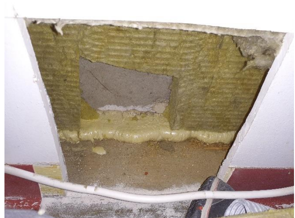
Kuva 62. Mikrobianalyysin perusteella ulkoseinän eristeen alaosa (Näyte 6, MIK9236) ei todettu viitettä vauriosta, mutta tuulensuojalevyn alaosa (Näyte 7, MIK9236) todettiin viite vauriosta.
