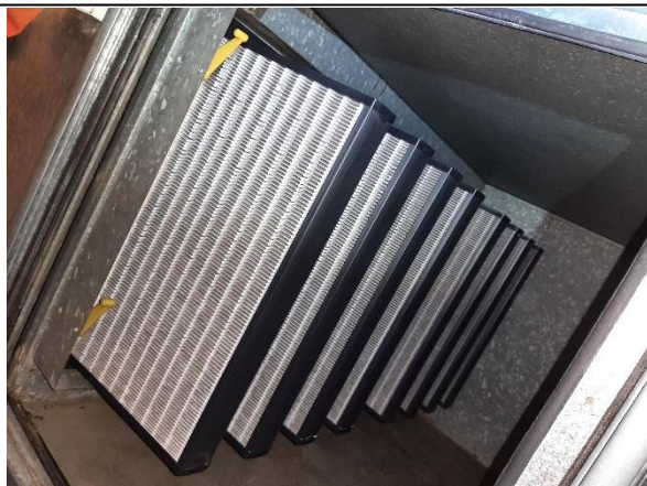
Kuva 113. Päiväkodin tilojen tuloilmakoneen suodatinkammion pohjalla on hyönteisiä.
