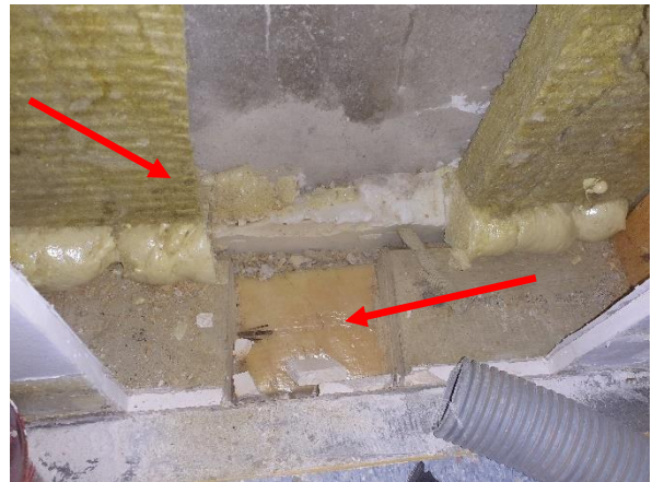
Kuva 38. Alaohjauspuun alla olevassa muovipinnoitetussa villassa (Näyte 2, MIK9231) sekä tuulensuojalevyssä (Näyte 3, MIK9231) todettiin viite vauriosta mikrobianalyysin perusteella.
