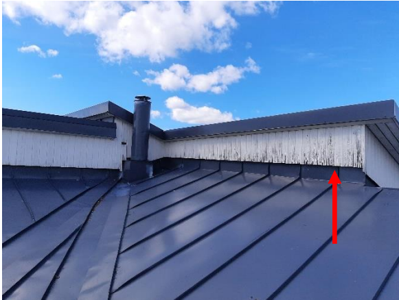
Kuva 95. Vesikatteen korotusosan seinälaudoitus on paikoin hyvin huonokuntoinen.
