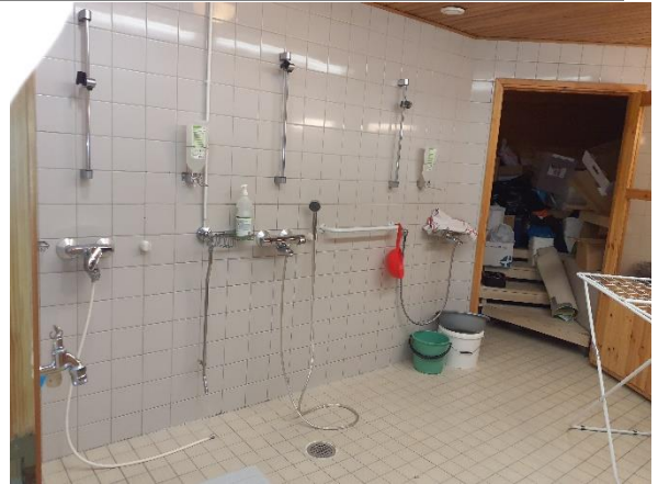
Kuva 100. Pesuhuoneen A102 seinäpintakosteusarvot: 45-95.
