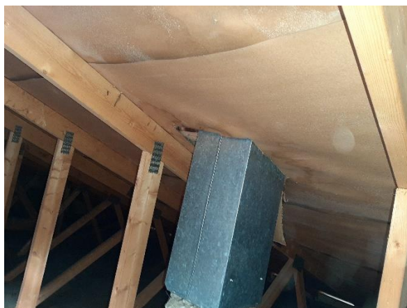
Kuva 68. Vesikatteen läpivientikohdassa kosteusvaurioita aluskatteessa. Kuva Oravanpesän kohdalla.
