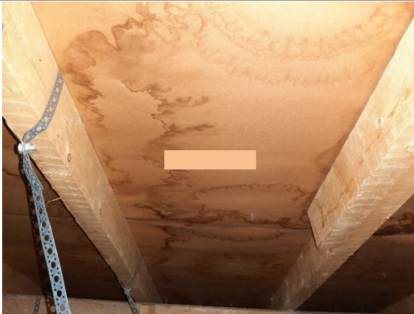
Kuva 79. Myyränmajan ja Ketun kolon välikäytävän kohdalla kosteusvauriojälkiä aluskatteessa.
