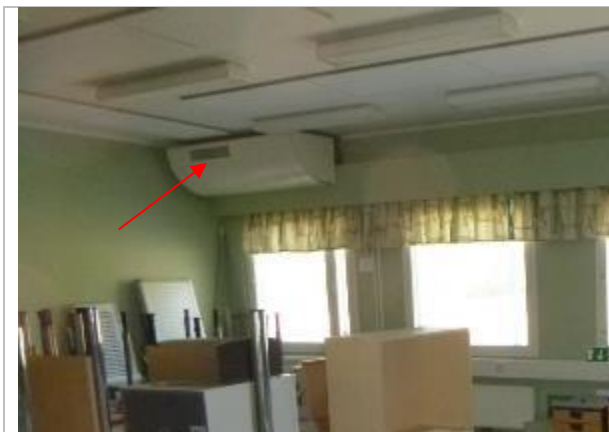
Osassa tiloista on erilliset tuloilmalaitteet.
