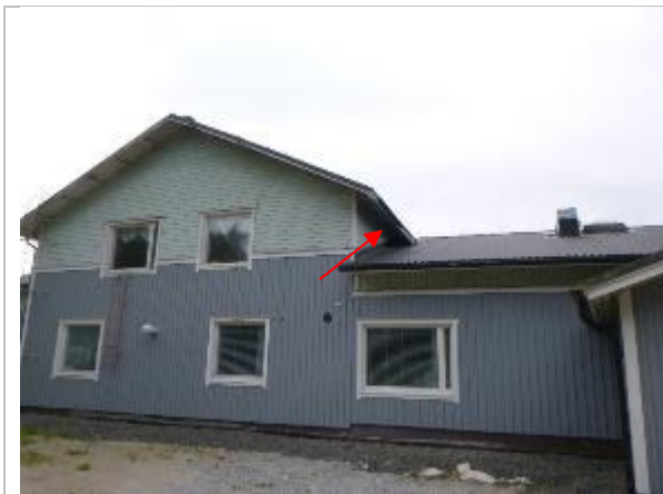
Tässä nurkassa räystään alla on reikä ja eläimillä pääsy yläpohjaan.
