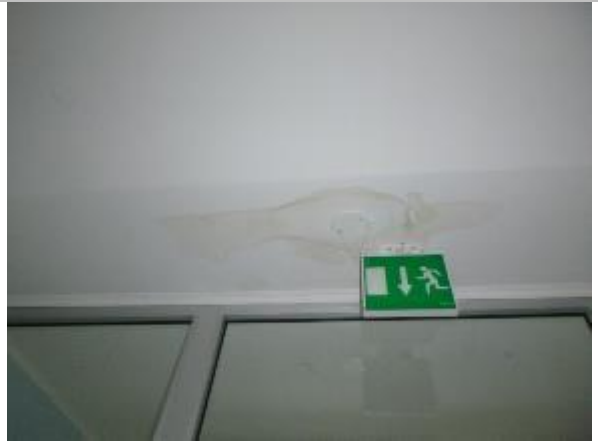
Vuotojälkiä aulan katossa.
