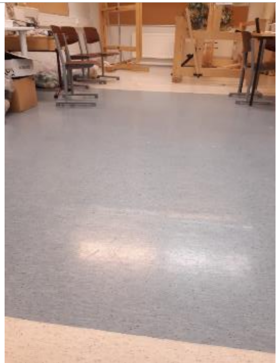
Lattia on oven edustalta painunut.
