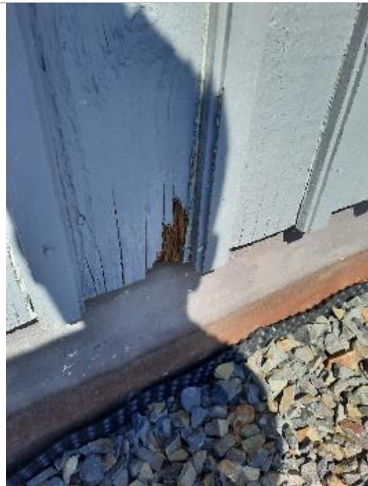
Ulkoverhouslaudoitus on paikoin lahovaurioitunut.
