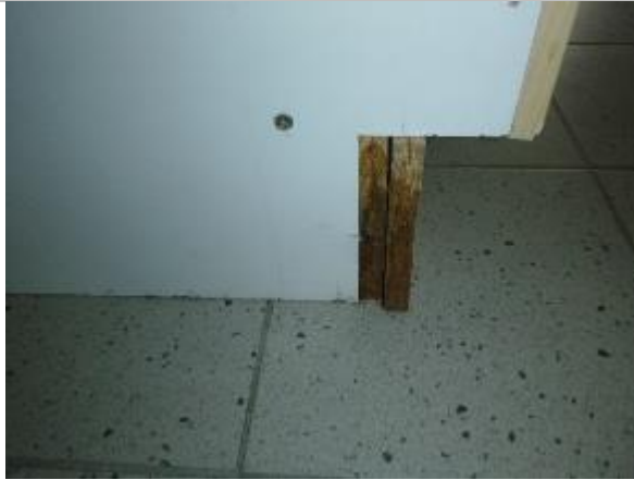
Aulassa olevan kaapin alasokkeli on vaurioitunut.
