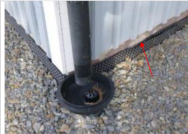
Patolevyn yläreunasta puuttuu reunalista.
