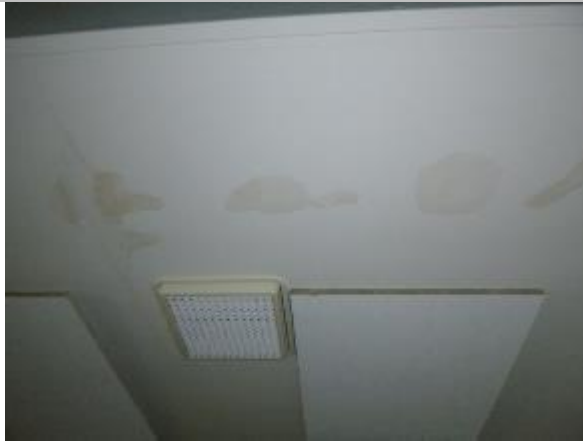
Vuotojälkiä aulan katossa.
