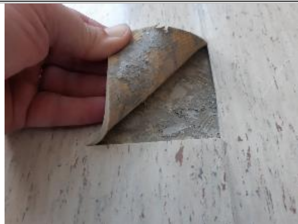
Muovimaton alla oli havaittavissa poikkeavaa hajua.
