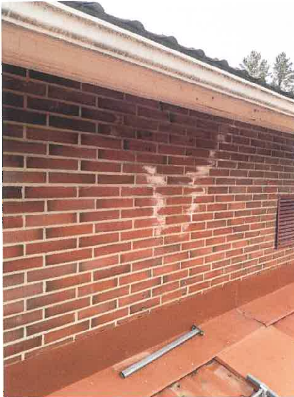
Kuva 12. Kattovuodon aiheuttamaa härmettä liikuntasalin seinän yläosassa.
