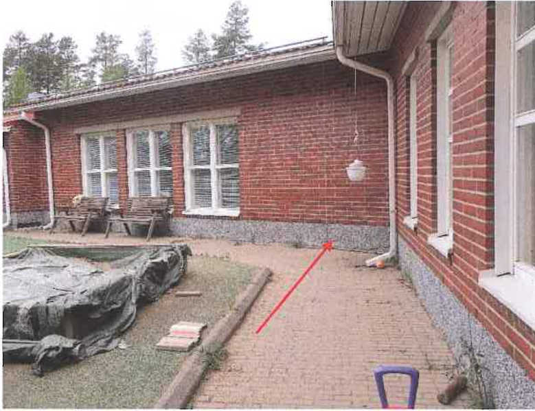
Kuva 8. Sokkelin rappaus paikoin irronnut.
