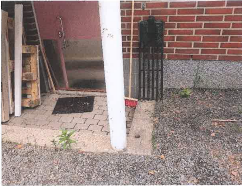
Kuva 6. Liikuntasalin puoleisessa päädyssä lattiapinta noin 15 cm maanpintaa alempana.
