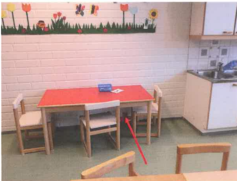
Kuva 15. Näyte 10, tila 143 ulkoseinän alaosa.
