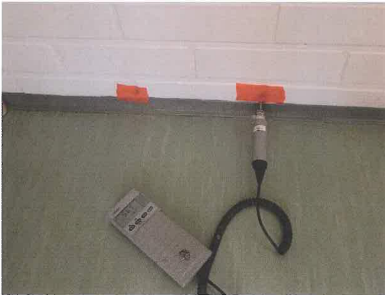
Kuva 9. Tila 151, ulkoseinärakenteen kosteusmittaus. Näyte nro 2 otettu mittauskohdalta.
