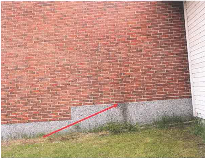
Kuva 14. Räystäspellin sauman kohdalta tippunut vesi kastellut seinän alaosa tilan 143 kohdalla.
