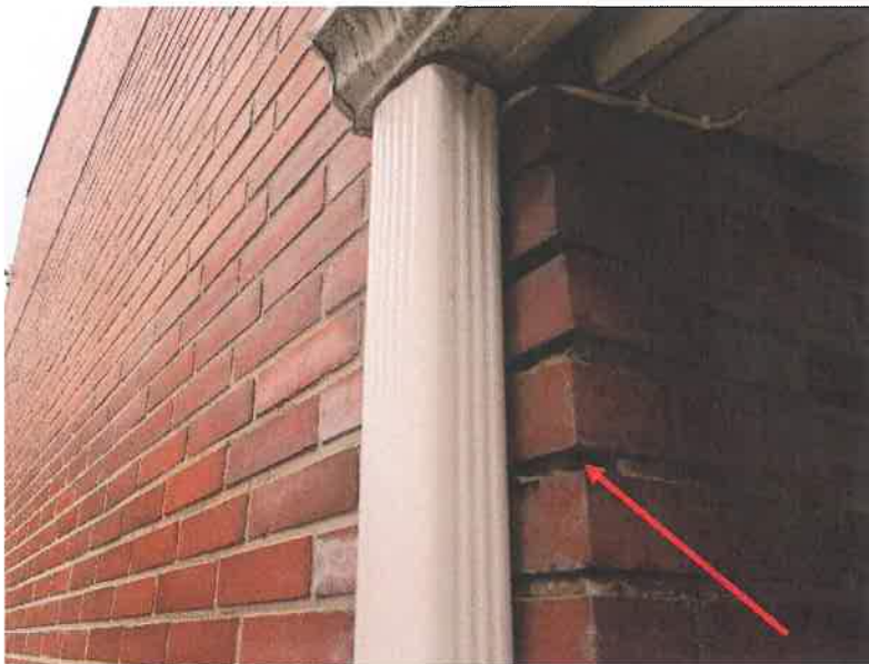
Kuva 11. Tiiliverhouksen saumat rapautuneet liikuntasalin nurkassa.
