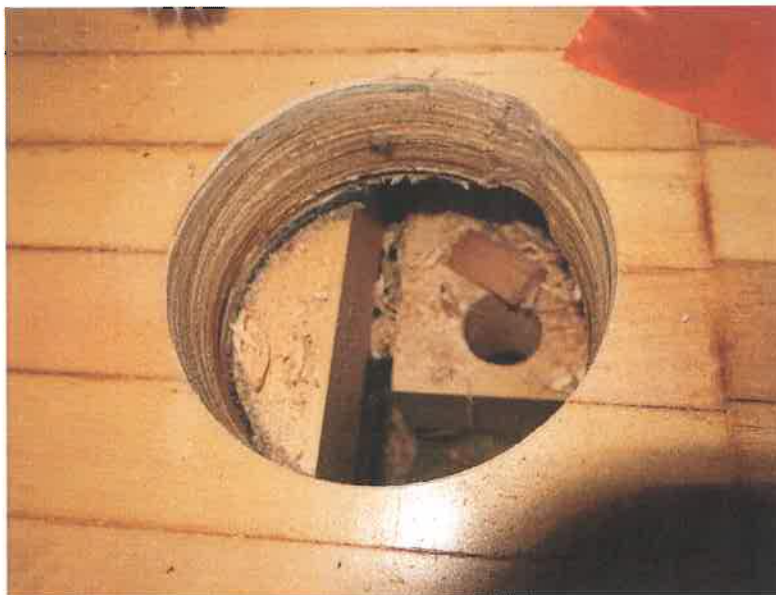
Kuva 5. Liikuntasalin lattian rakenneavaus. Ko. kohdalta villaeristeestä näyte 7.
