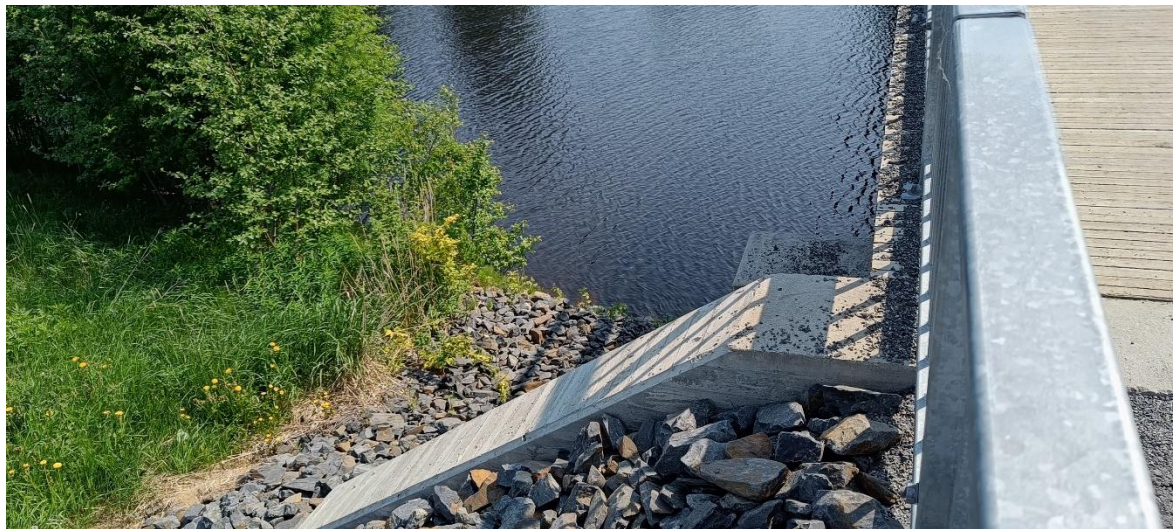
Kuva 10 Jukkalan kevyen liikenteen sillan penkat levittyvät viereisen AO-tontin puolelle
